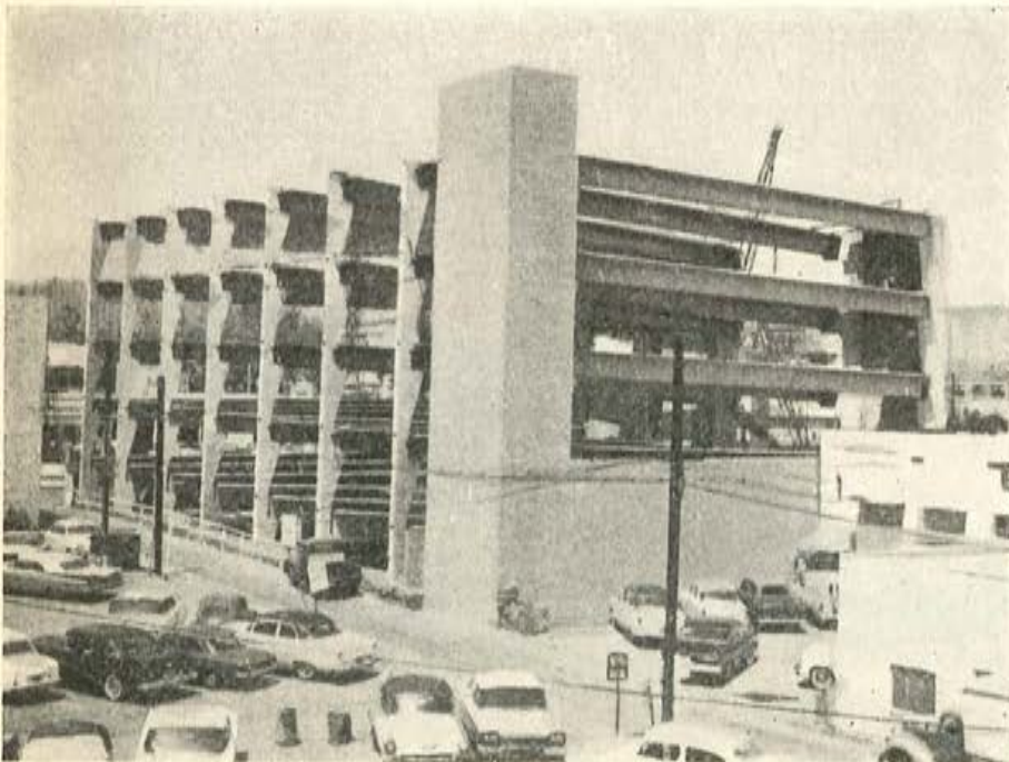
Garaje en Beverley Hills (California): Sus dimensiones totales son: 48,70 × 45,60 m. Mediante el empleo de vigas pretensadas se han conseguido luces libres de 22,80 m, dobles de las previstas inicialmente con una solución a base de vigas de hormigón armado.
