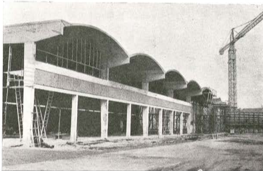
Fig. 6.— En esta obra no ha habido problemas para el suministro de energía eléctrica; durante el día, la electricidad se utilizó para el funcionamiento de las grúas y, durante la noche, para el endurecimiento de una viga transversal o de una de las cubiertas laminadas de hormigón.
