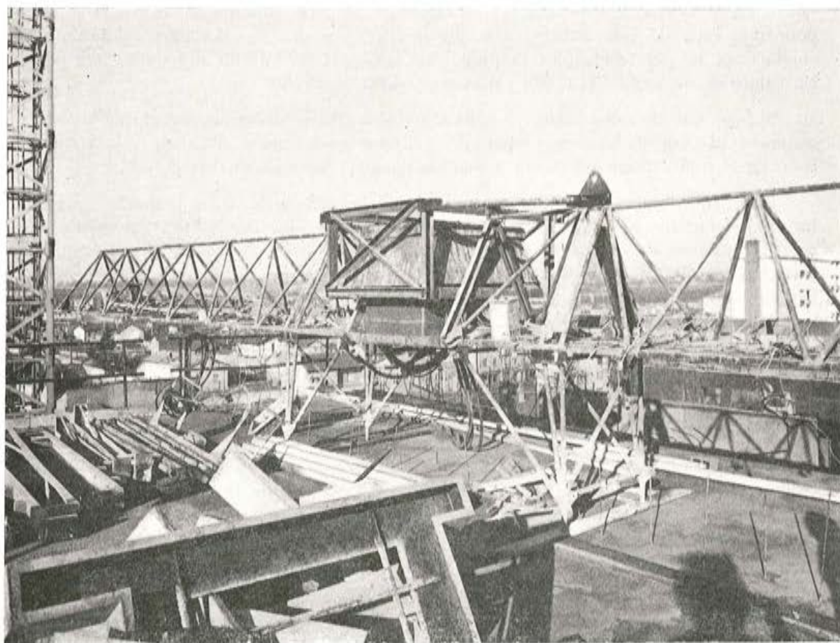
Fig. 4. — Iniciación de las operaciones de endurecimiento de los forjados mediante el empleo de resistencias eléctricas, en un conjunto de edificios constituido por 300 viviendas. La potencia eléctrica utilizada, de muy baja tensión — inferior a 50 voltios —, era del orden de 120 kW, para una superficie unitaria de 185 metros cuadrados.
