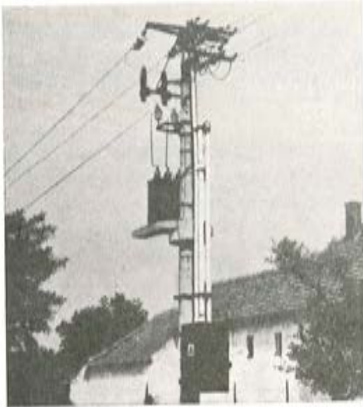
Fig. 3. — Poste simple con transformador incorporado.
