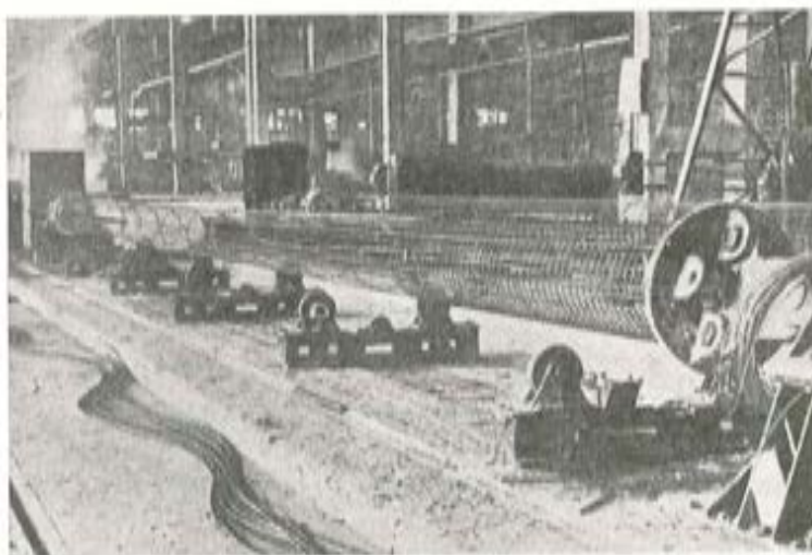
Fig. 15. — Vista de las armaduras longitudinales, helicoidales y estribos. En primer plano pueden verse los cables pretesosos.
