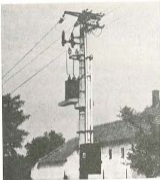
Fig. 3. — Poste simple con transformador incorporado.
