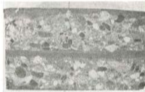
Fig. 6. — Sección típica de la pared de una tubería de hormigón, centrifugada, en la que se distinguen perfectamente las dos capas del hormigonado.
