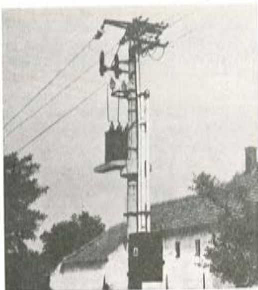
Fig. 3. — Poste simple con transformador incorporado.
