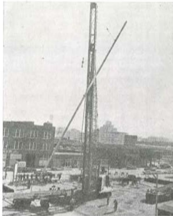
Pilote pretensado de gran longitud, de una sola pieza, utilizado para la cimentación de un edificio en una ciudad americana.
