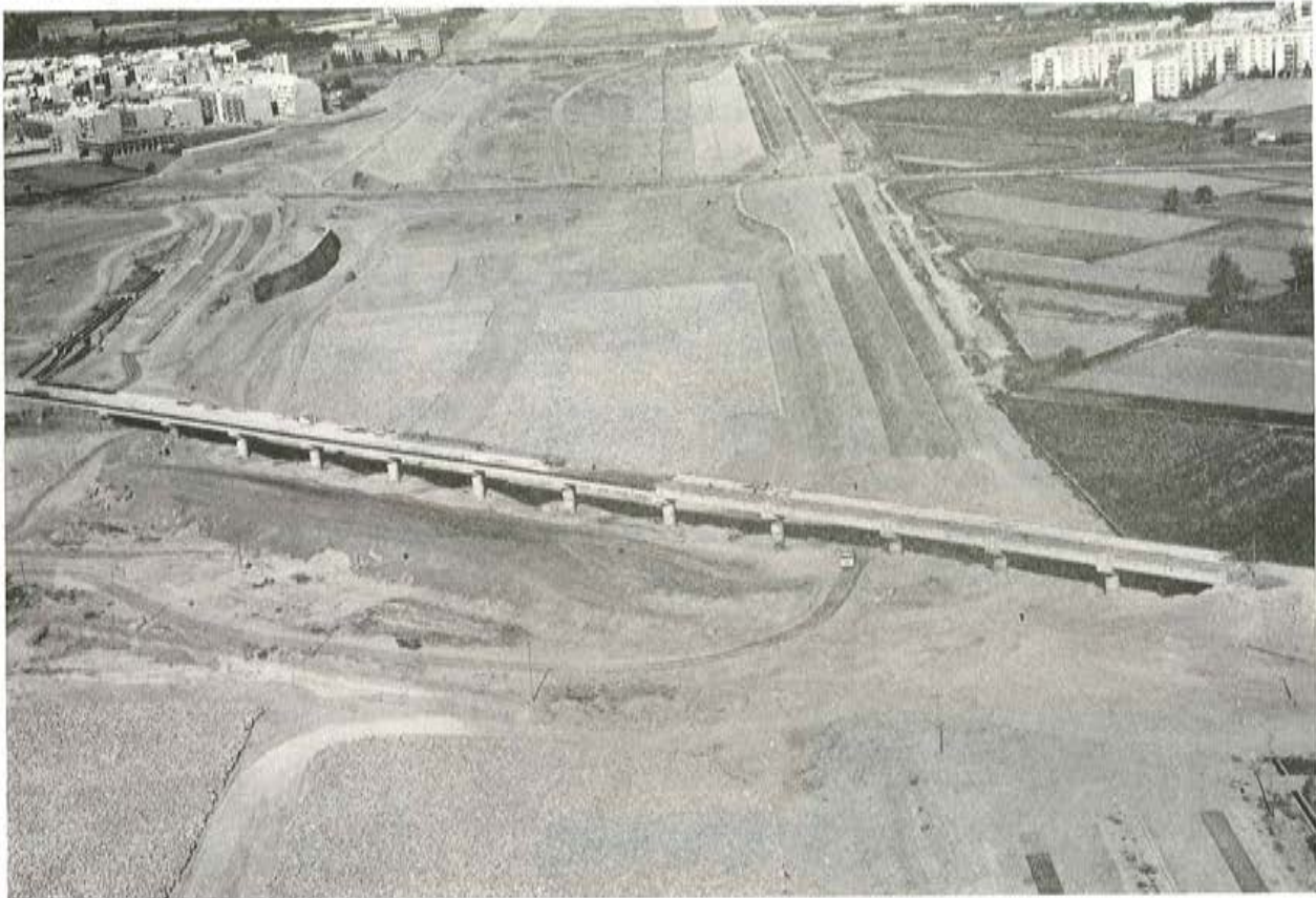
Puente FF.CC. Liria-Utiel (Plan Sur de Valencia) Construye: CUBIERTAS Y TEJADOS, S. A. Proyecto: Florencio del Pozo
