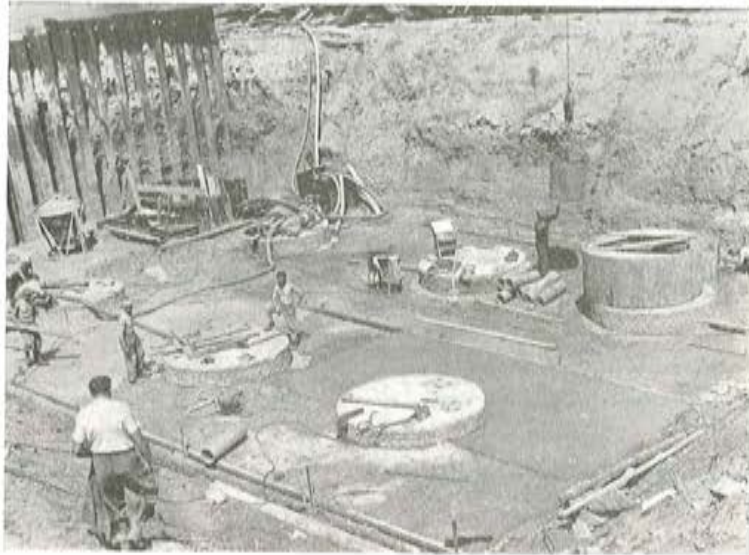
Vista de las cabezas de los pilotes de cimentación para una de las pilas.
