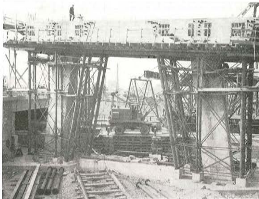
Fig. 55. — Vista de la cara de la riostra de apoyo con los anclajes del primer grupo de cables y los tubos en espera para los del segundo grupo.
