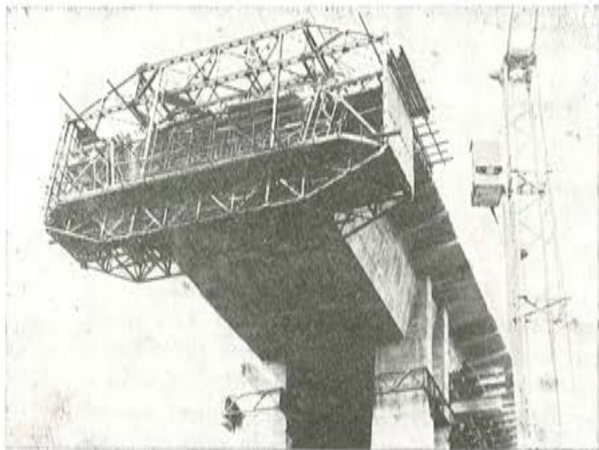
Detalle del carretón con el encofrado móvil, para la construcción de los tramos en voladizo.
