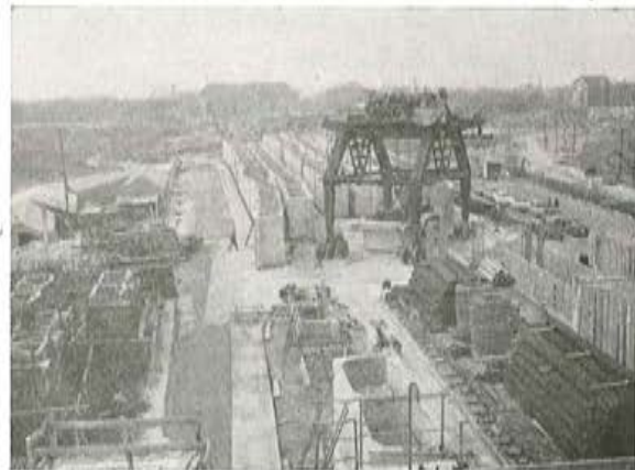
Fig. 24. — Conjunto del parque de almacenamiento en el estribo de Saint-Denis. En primer plano, a la derecha, el almacén de placas de forjado.
