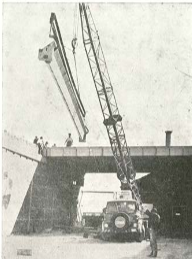
Montaje de una pieza de 16 m. de luz de 17 000 Kg. de peso propio.
