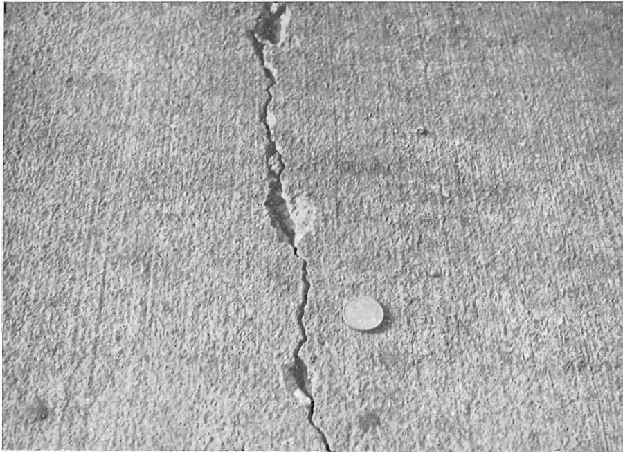
Grieta transversal abierta, desconchada superficialmente, en una losa del sistema fijo.
