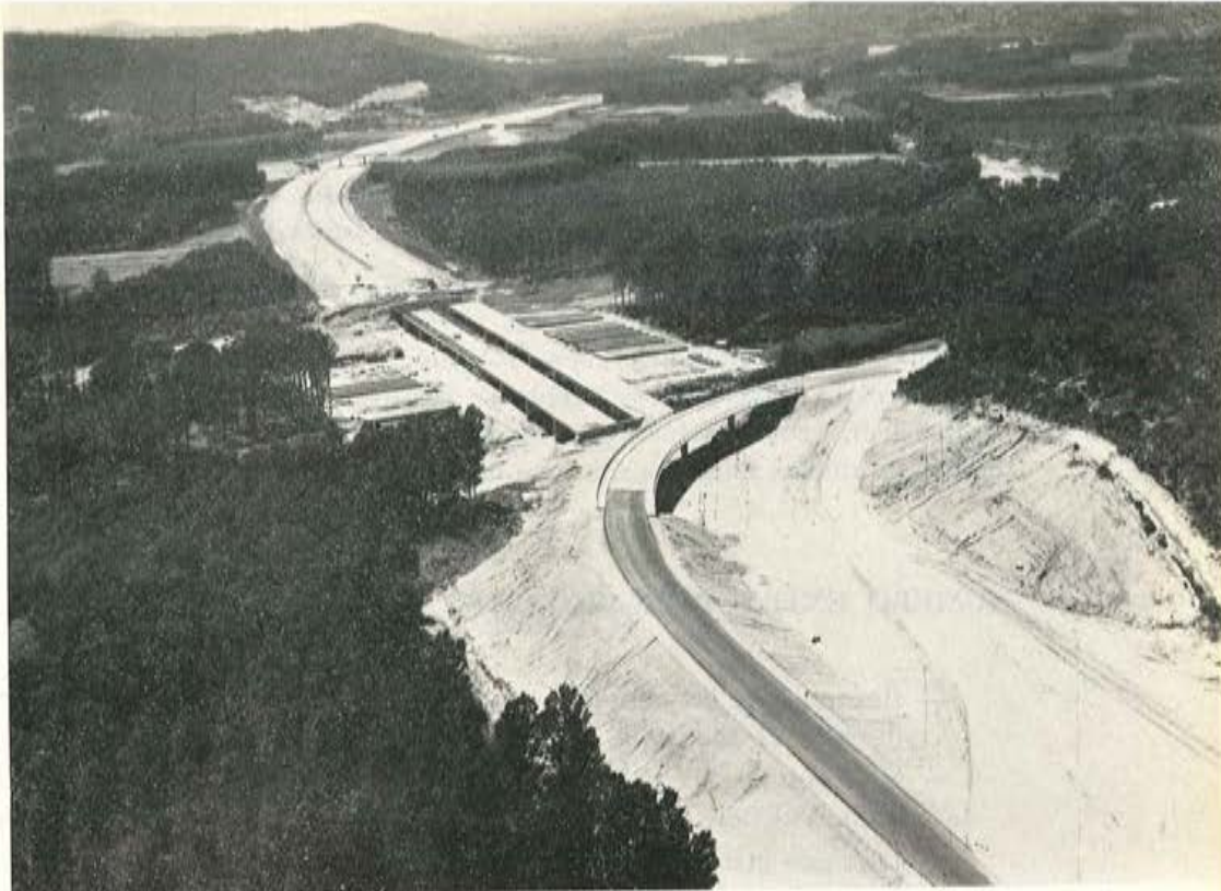
Autopista Barcelona - La Junquera. Puente sobre el río Ter y dos pasos superiores.
