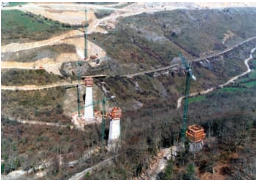
Figura 9. Vista general de ejecución de alzados de pilas. Figure 9. General view of the pier elevation construction.
