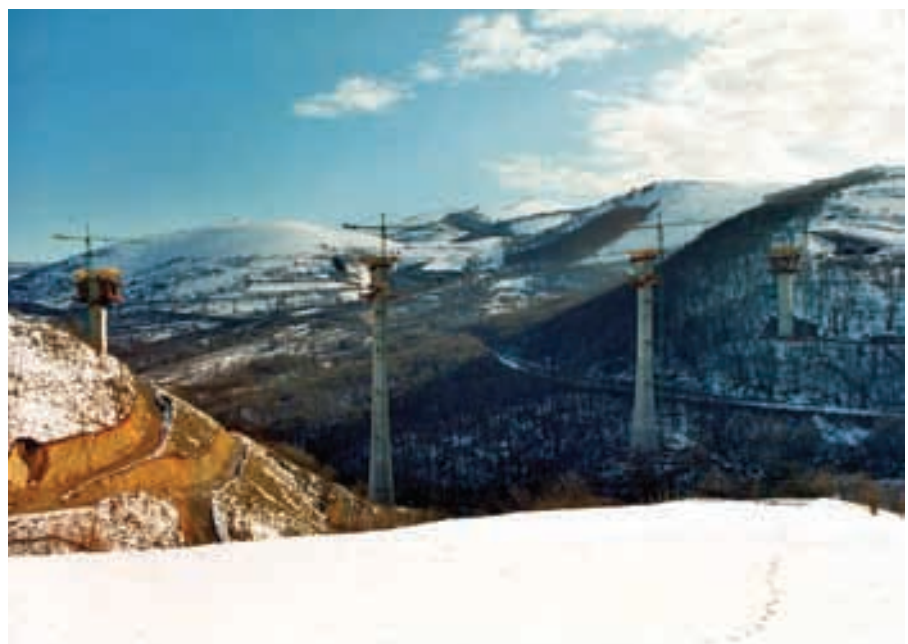
Figura 26. Alzado longitudinal de pilas con dovelas "0" terminadas. Figure 26. Longitudinal elevation of the piers with "0" segments finished.
