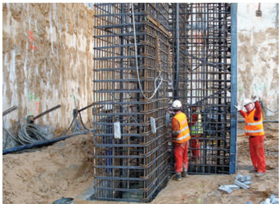
Figura 7. Ferralla para paneles de pantallas de cimentación. Figure 7. Rebar for foundation walls.
