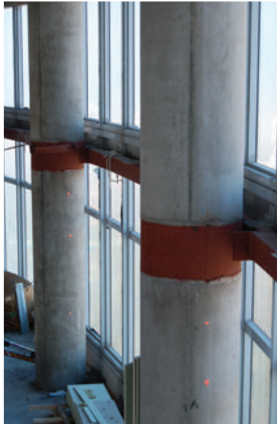
Figura 24. Estructura metálica auxiliar para sujeción de la fachada: vista general (izqda.); detalle de conexión con los soportes (dcha.).
