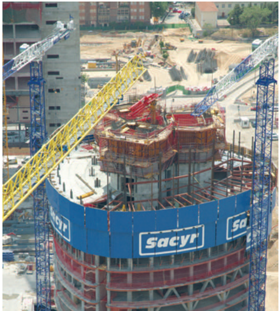
Figura 24. Vista general de la obra en una de las plantas tipo en la que se muestra la superposición de las actividades de construcción del núcleo mediante autotrepa y de la estructura metálica de la planta.
