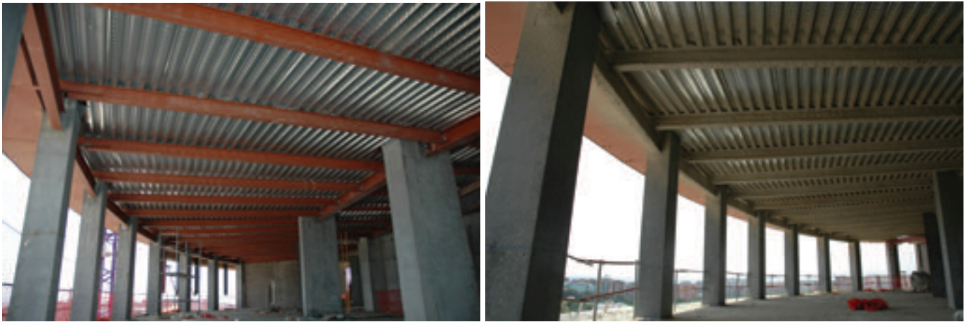
Figura 28. Vista inferior de un forjado tipo antes y después de aplicar la protección ignífuga a las vigas y viguetas. Figure 28. Bottom view of a standard slab before and after the application of the fire protection on the beams and joists.
