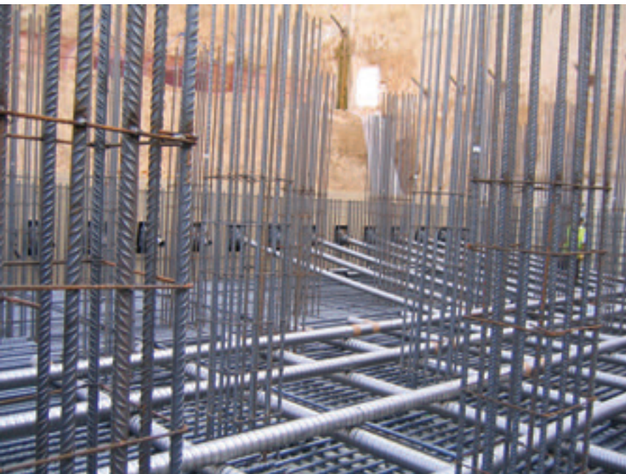
Figura 4. Detalle de la interferencia entre la armadura pasiva de flexión, los cables de pretensado y la armadura de cortante.
