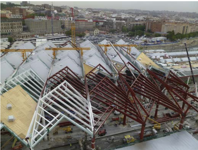
Figura 51. Puentes grúa sobre la cubierta alta.
