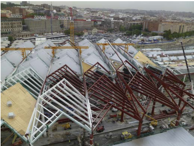
Figura 51. Puentes grúa sobre la cubierta alta.
