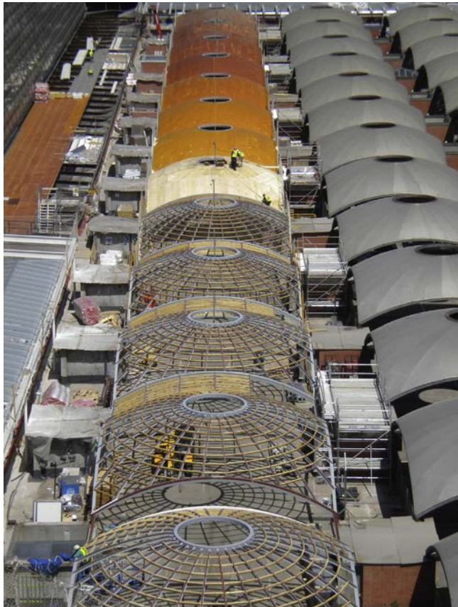
Figura 8. Vista de las cúpulas que cubren el pasillo rodante, durante la ejecución de las obras.
