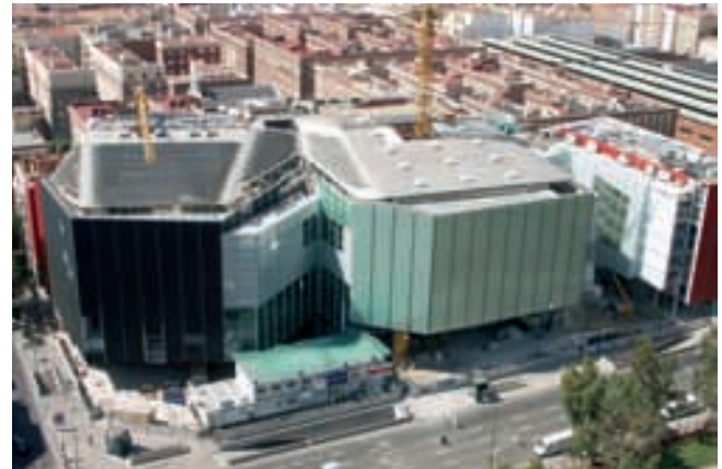
Figura 42. Vista frontal del edificio en sus últimas fases de construcción Figure 42. Frontal view of the building in its final phase of construction.
