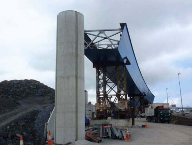
Figura 28. Pilas de los ramales de acceso.
