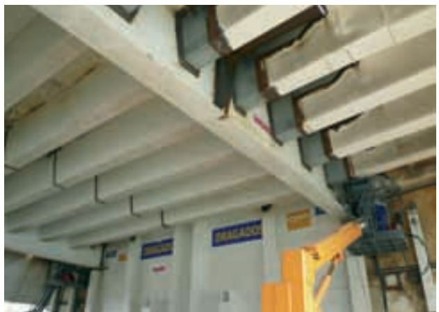
Figura 35. Unión entre tramos nuevos y existentes. Figure 35. Bond between new and existing sections.
