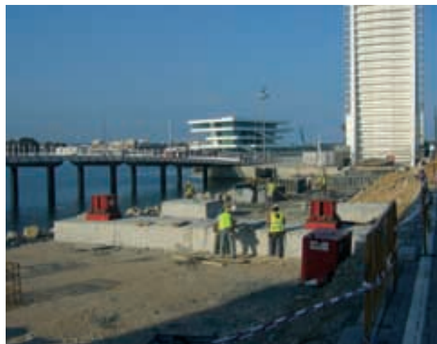
Figura 26. Ejecución de apeos sobre el relleno de la bocana. Figure 26. Fill at harbour neck to provide provisional shoring for the deck sections.
