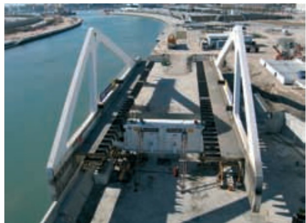
Figura 34. Semihojas en posición antes de incorporar los nuevos tramos centrales de 10 m. de anchura. Figure 34. Half-leaves in position before inserting the new 10-m central sections.
