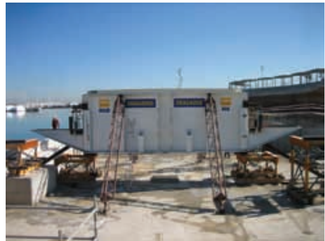
Figura 7. Gran viga de rótula a la espera de recibir a las vigas principales.
