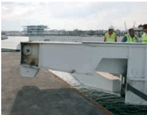
Figura 16. Hoja 2 "barriando" en el giro por encima de la hoja 1 basculada. Figure 16. Leaf 2 clearing tilted leaf 1.
