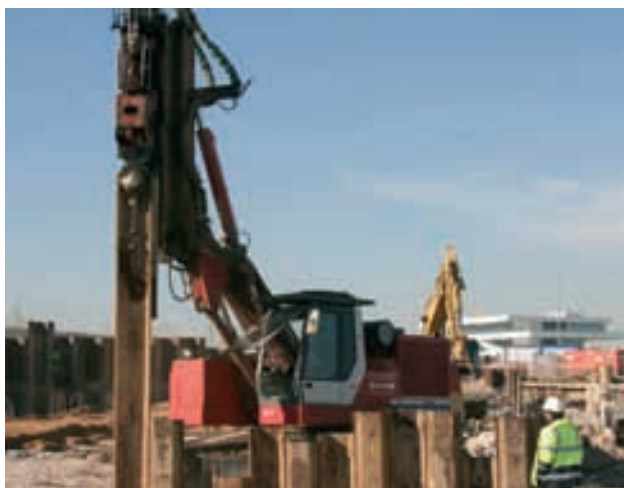
Figura 21. Hinca de tablestacas alrededor de cada recinto. Figure 21. Driving sheet piles around each pit.
