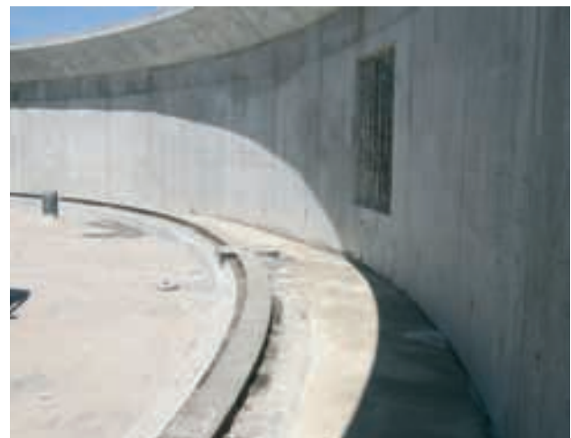
Figura 19. Carril de rodadura. Figure 19. Roller tracks.
