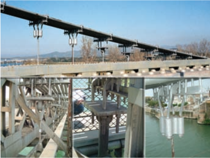
Figura 23. Péndolas tipo I, tipo II y tipo III. Figure 23. Type I, type II and type III suspenders.
