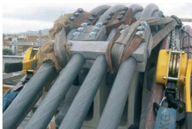
Figura 18. Sistema antideslizante de los cables principales nuevos. Figure 18. Anti-slip system for new main cables.
