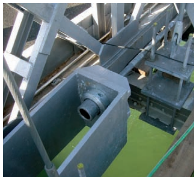
Figura 29. Nuevo cable horizontal y su terminal activo.
