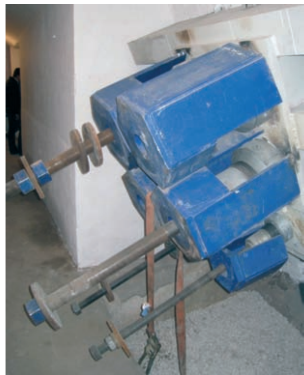
Figura 33. Interior de las cámaras de anclaje rehabilitadas. Figure 33. Rehabilitated anchorage chamber interiors.
