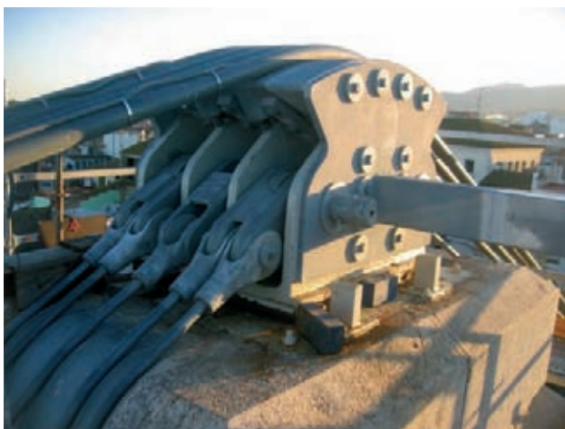
Figura 27. Una de las sillas rehabilitada, mostrando la cara de los terminales de tirantes.
