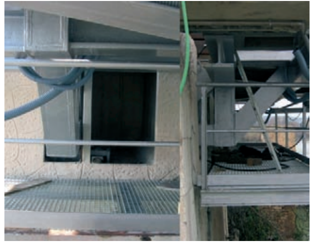
Figura 32. Exterior de las cámaras de apoyos y sus accesos. Figure 32. Support chamber exteriors and accesses.
