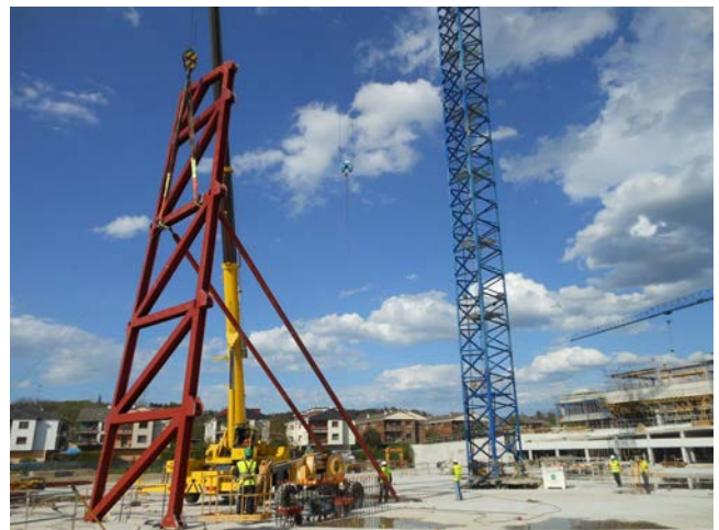
Figura 24. Montaje del primer paño de celosía. Obsérvense los puntales provisionales colocados para dotar a la estructura de estabilidad durante el proceso.
