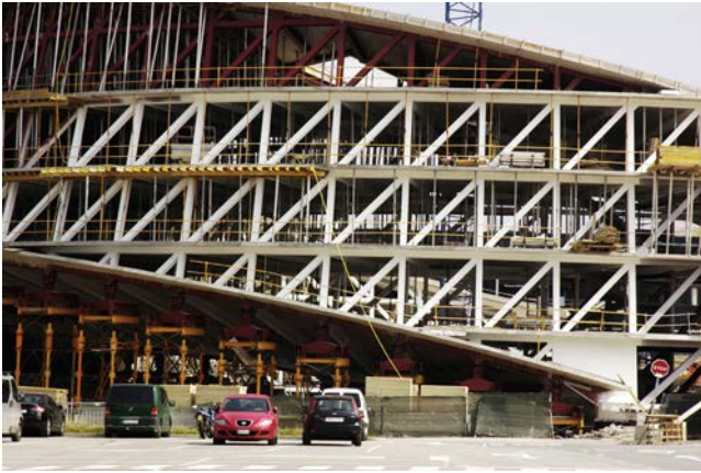
Figura 8. Vista lateral de la celosía exterior durante la ejecución del forjado de cubierta. Obsérvese cómo las diagonales mantienen su directriz recta en los encuentros con los forjados de fondo y cubierta.
