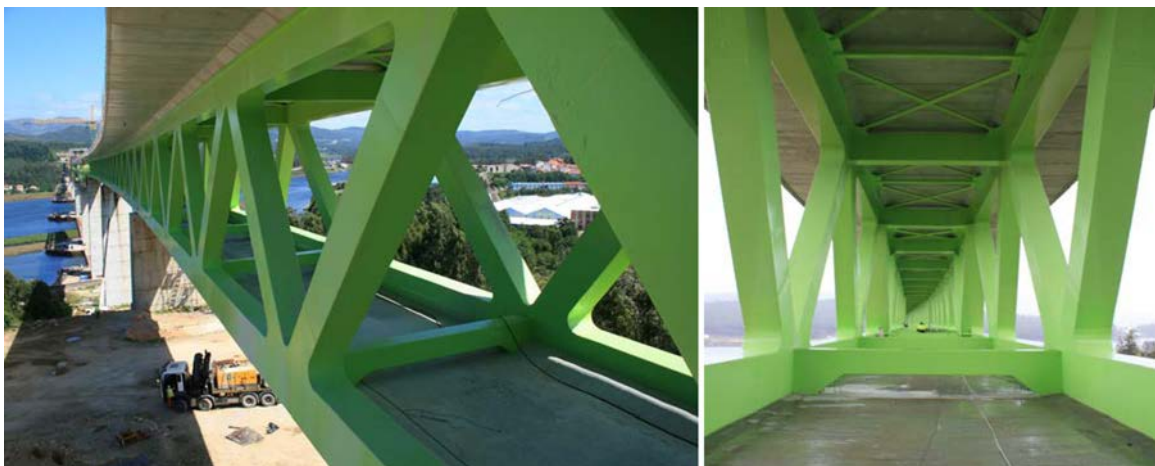
Figura 4. Vista lateral y del interior de la sección transversal desde el hormigón inferior.
