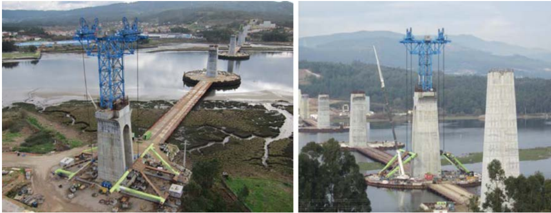
Figura 30. Ejecución de dovela cero en el pie de pila y operación de verticalizado.
