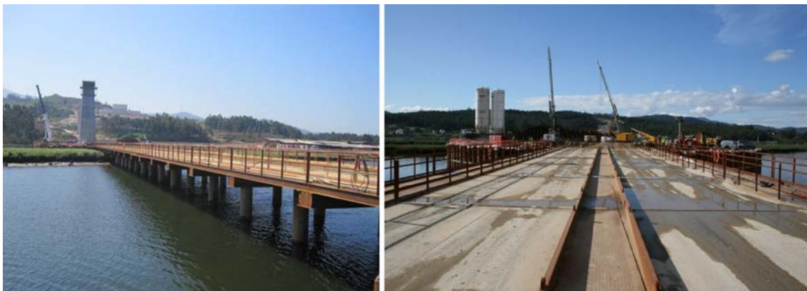
Figura 6. Vistas del pantalán de acceso a las cimentaciones de las pilas P-5, P-6 y P-7.
