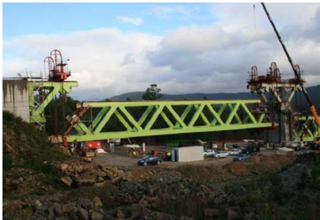
Figura 27. Secuencia del proceso de izado del vano lateral 12 entre el E-2 y la P-11. Izado de unas 465 t.
