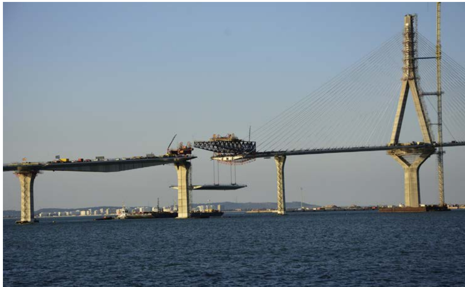
Figura 7. Cierre lateral con el puente desmontable.
