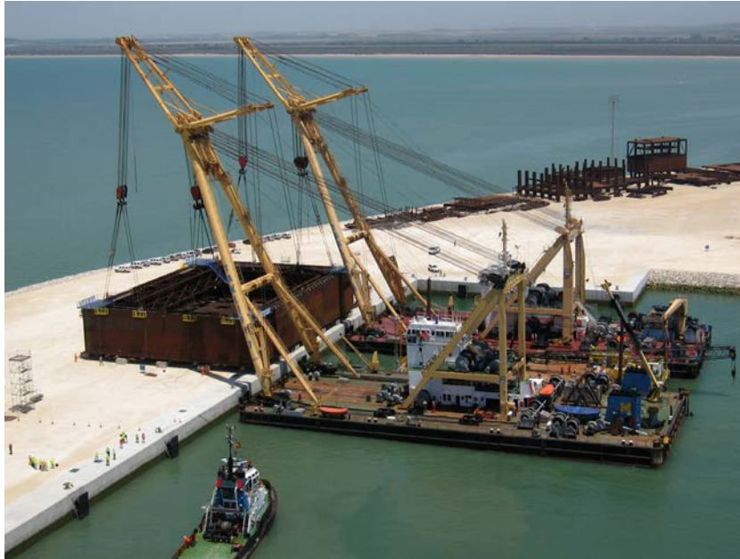
Figura 3. Carga del recinto estanco para la cimentación del pilono situado en el mar.
