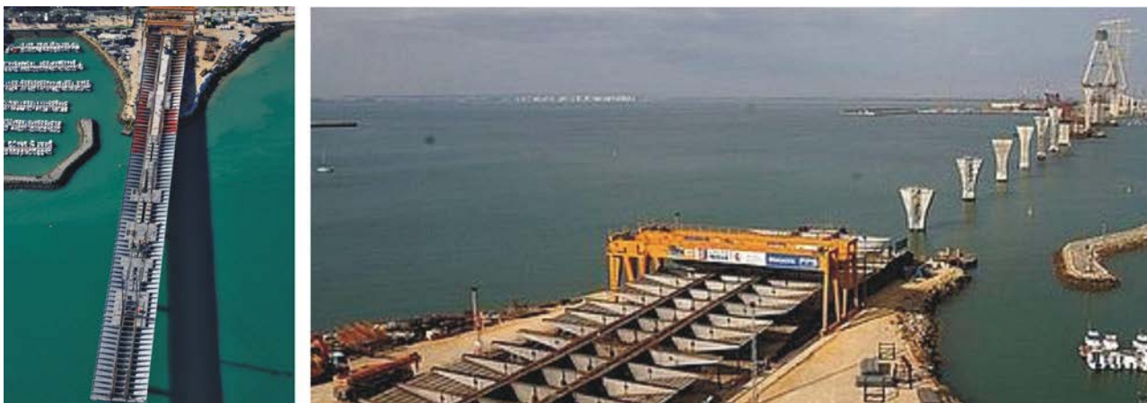
Figura 14. Otras vistas del proceso de empuje del tablero del viaducto al lado del acceso a Cádiz.
