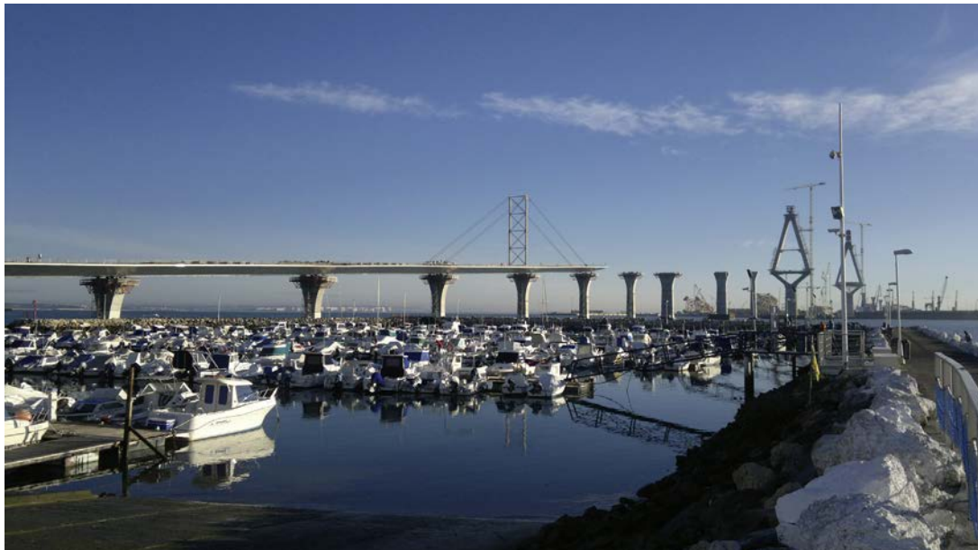
Figura 5. Puente de acceso desde Cádiz. Proceso de empuje de la parte metálica.
