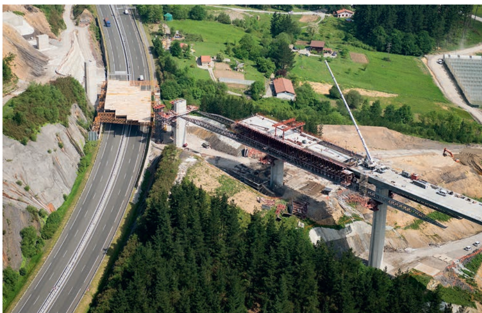
Figura 25. Vista de la zona de negativos completamente hormigonada y colocación de prelosas en el tramo de positivos sobre el que se ferrallará y hormigonará la losa posteriormente.
