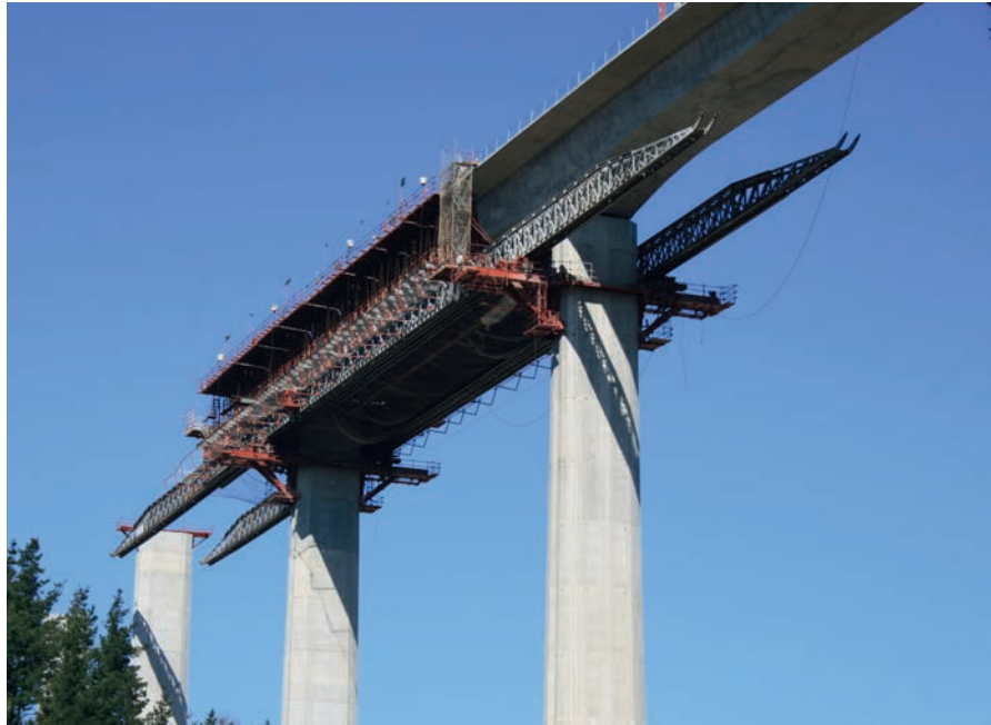
Figura 32. Imagen de los anillos de apoyo de la autocimbra en cabeza de pilas.
