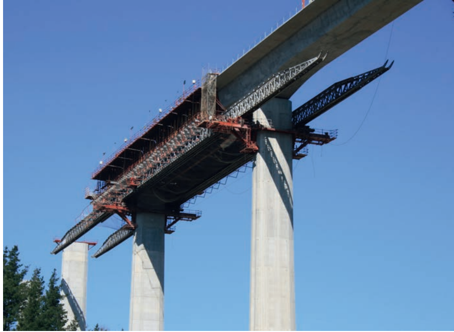
Figura 32. Imagen de los anillos de apoyo de la autocimbra en cabeza de pilas.
