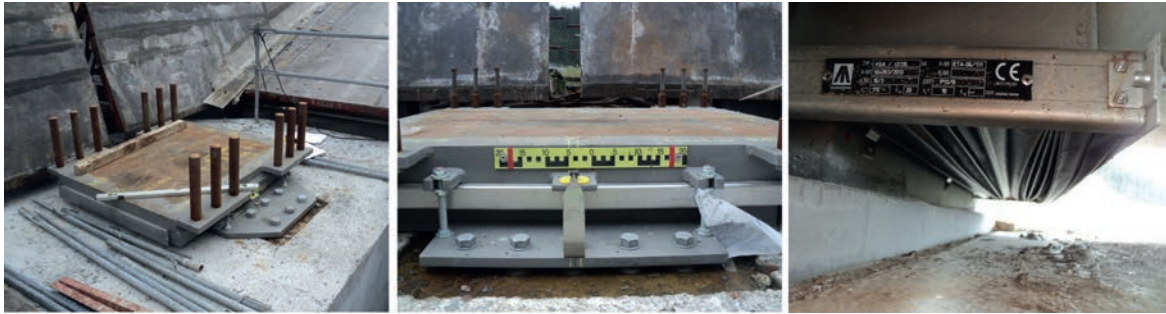
Figura 13. Vista de un apoyo, sistema de medición con regleta y protección guardapolvo.
