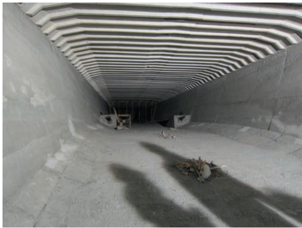
Figura 27. Vista del interior de la sección transversal con los anclajes de pretensado de positivos al fondo.
