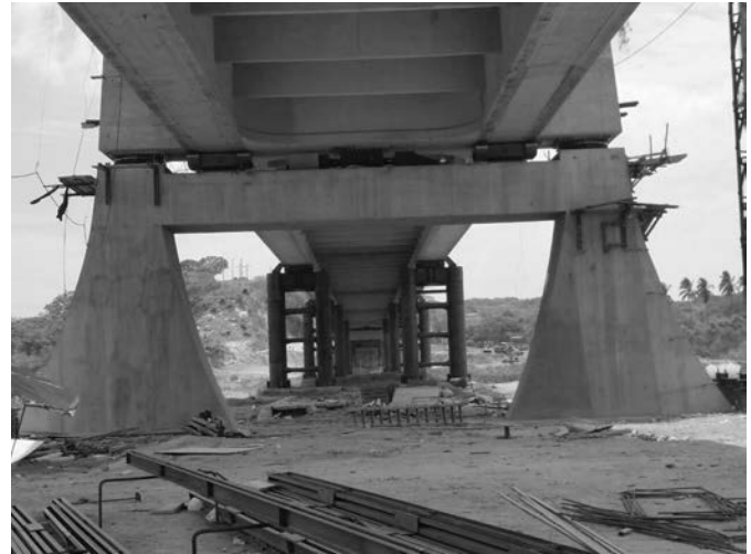
Figura 14. Vista de la torre 5, donde se aprecia el amortiguador transversal y los apoyos pendulares.
