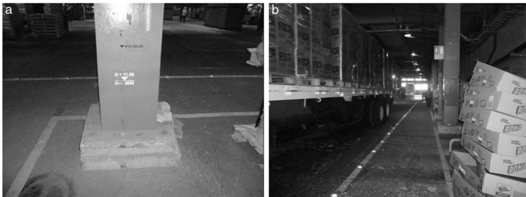
Figura 4. Desnivel en pasillo central (véase los dados de las columnas).
