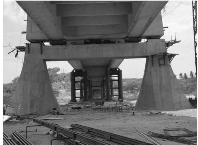
Figura 14. Vista de la torre 5, donde se aprecia el amortiguador transversal y los apoyos pendulares.
