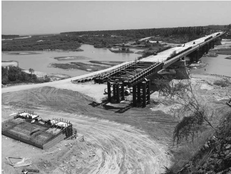
Figura 12. Puente Barra Vieja. Empuje del tablero donde se ven los topes transversales.
