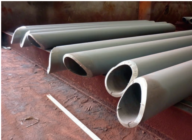
Figura 10. Corte y preparación de bordes en extremos de los tubos que constituyen las diagonales de las celosías.
