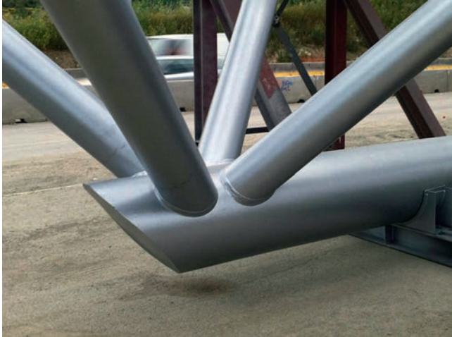
Figura 9. Nudo en uno de los extremos del cordón inferior de una celosía.
