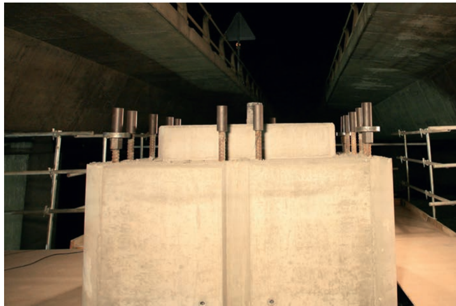
Figura 15. Cabeza superior de la fracción de pila construida in situ. Pueden verse barras salientes verticales de 50 mm de diámetro en situación previa a la operación de montaje de la pieza superior prefabricada. En las barras de esquina se han colocado tuercas de compresión y placas de apoyo por debajo de los manguitos de empalme. En el resto de las barras solamente se han colocado manguitos de empalme.
