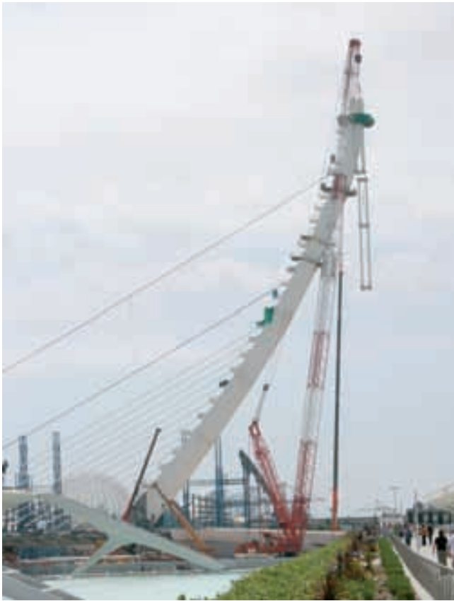
Figura 28. Montaje de tubos de retenida. Figure 28. Erection of back stay steel tubes.
