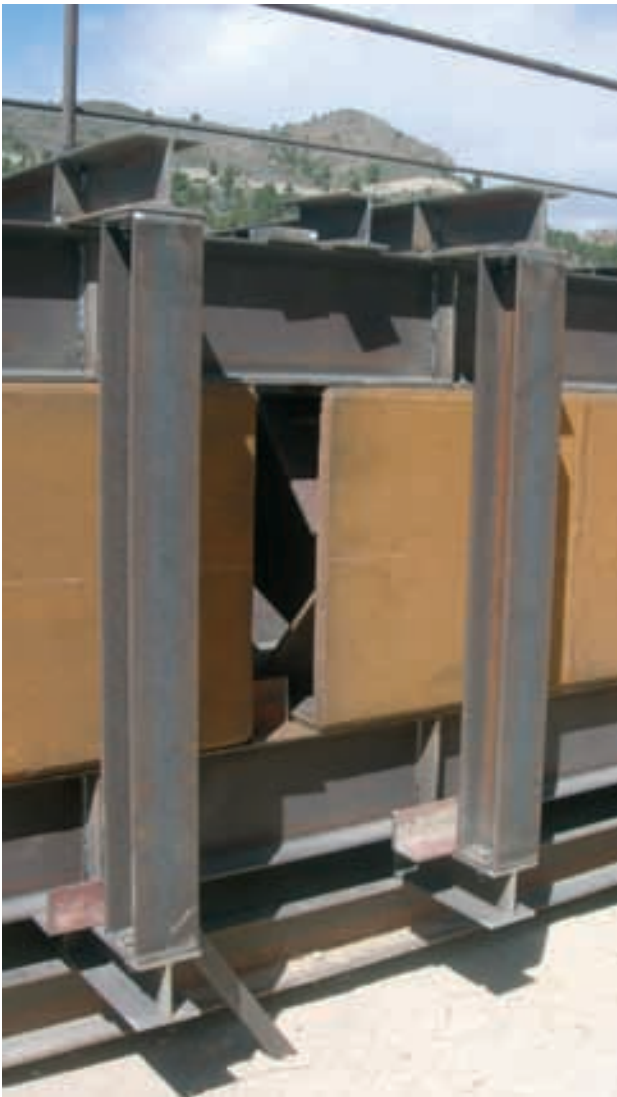
Figura 51. Apertura de riostra Figure 51. Gap in brace
