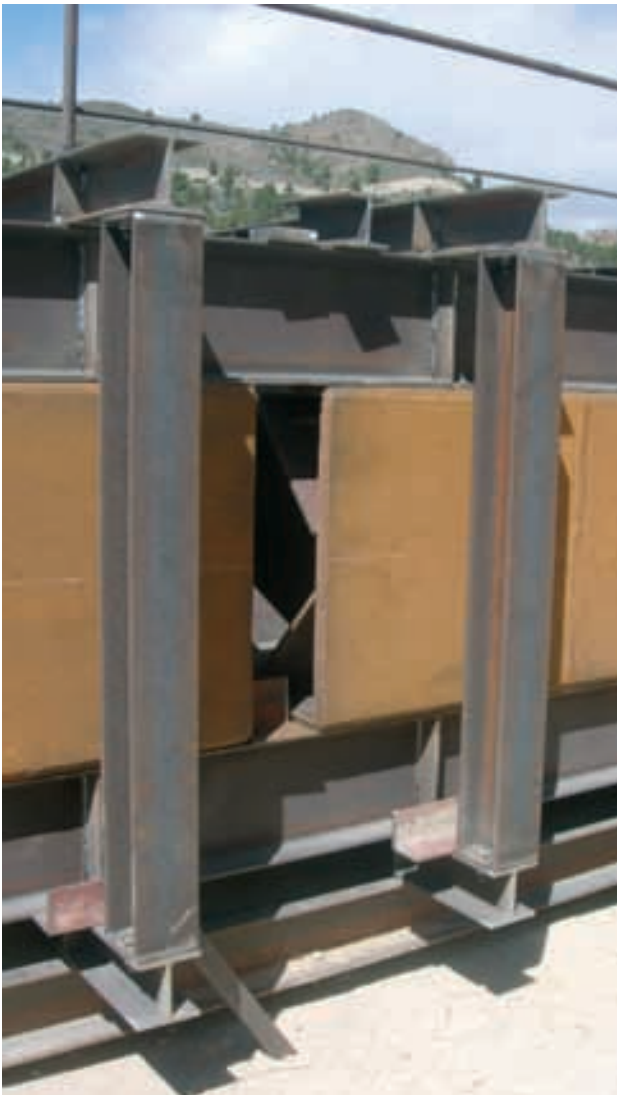
Figura 51. Apertura de riostra Figure 51. Gap in brace
