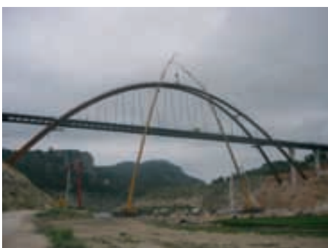
Figura 25. Hormigonado de una fase del arco Figure 25. Concrete casting in the arch
