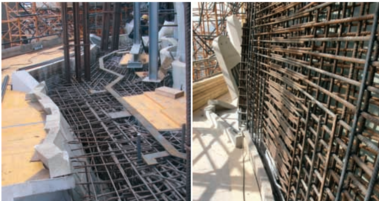
Figura 29. Ábside: a) armado de la base y b) armado del paramento Figure 29. Concrete placement in apse: a) base and b) wall reinforcement
