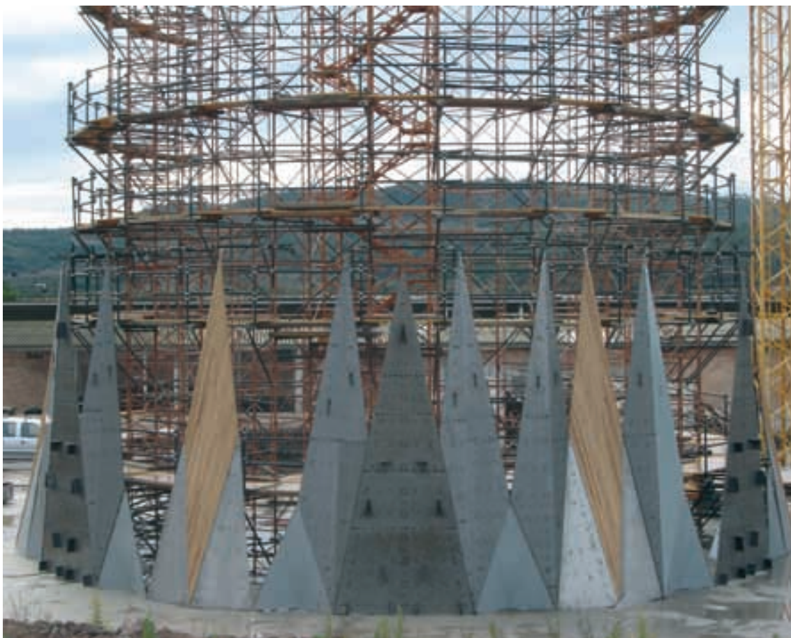
Figura 24. Diferentes tipos de encofrado utilizados en los muros del ábside. Fuente: ATESEF Figure 24. Formwork types used in the apse walls. Source: ATESEF
