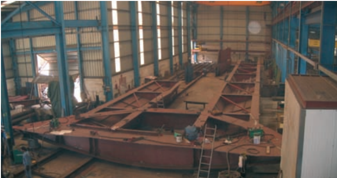
Figura 17a. Fabricación en taller de la riostra extrema del tablero Figure 17a. Deck's end diaphragm assembly at the steelworks
