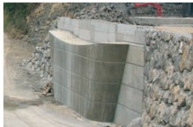
Figura 26. Estribo 2 del lado del puente arco antes del túnel Figure 26. Arch bridge abutment 2 before the tunnel
