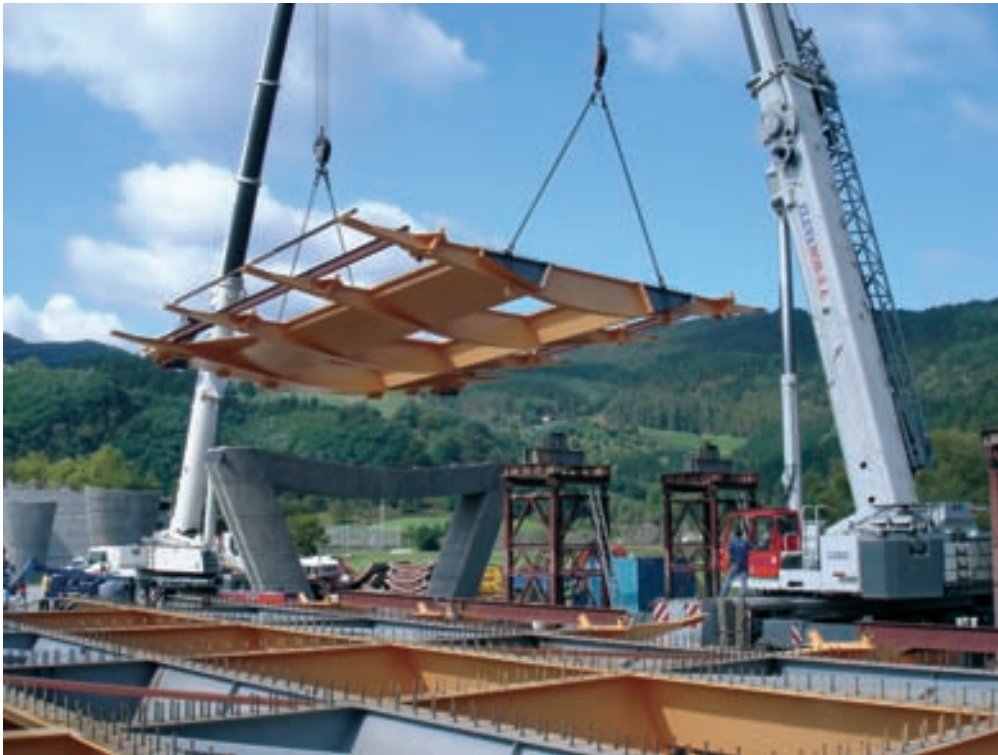
Figura 27. Secuencia de montaje de un tramo del tablero metálico Figura 27. Erection sequence of a steel deck segment
