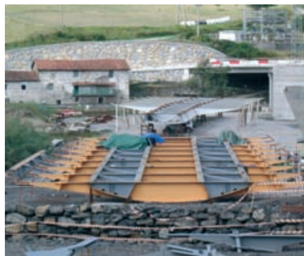
Figura 16. Vista del tablero del puente arco, en primer término, y del tablero del viaducto de acceso al fondo, previa a su colocación
