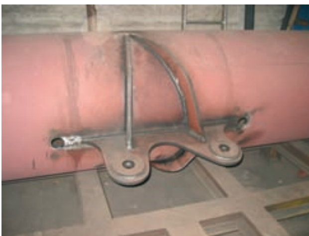
Figura 20. Detalle de las cartelas de unión superior de las péndolas con los tubos de los arcos Figure 20. Hanger-arch tube connection gusset plate detail
