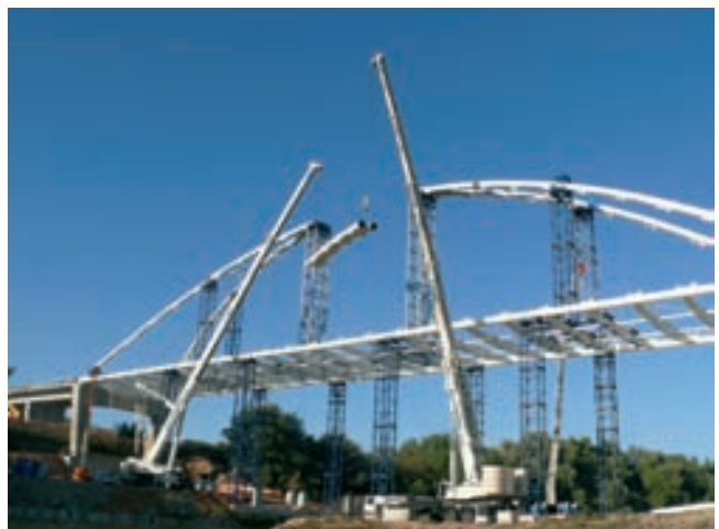
Figuras 41a y 41b. Vista durante las operaciones de izado de los arcos, y fase de cierre en clave de los arcos Figures 41a and 41b. Views of arch segments erection and arch crown closure
