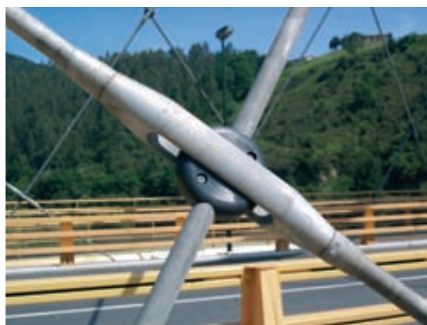
Figura 21b. Detalle de dispositivo de cruce de péndolas Figure 21b. Hanger crossing device close-up
