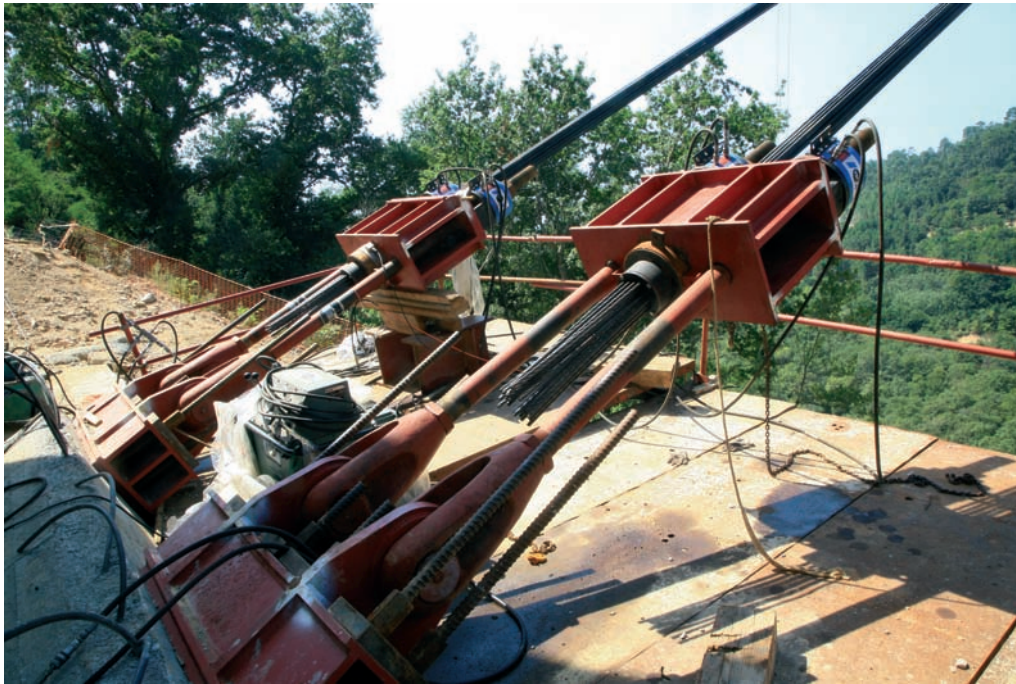
Figura 22. Estructura de transferencia en anclaje de retenida
