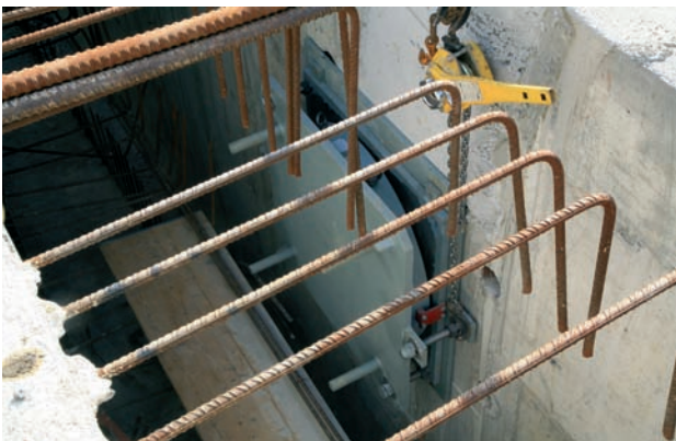
Figura 26. Apoyo POT instrumentado en estribo E1
