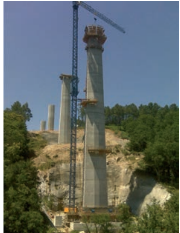
Figura 5. Construcción de la pila 12 del viaducto sobre Río Deza, de 96,50 m de altura
