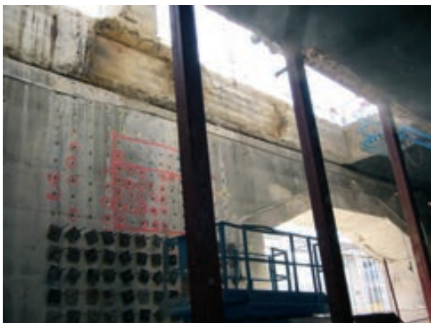
Figura 28. Huevo en muro, refuerzo muro y huevo en forjado
