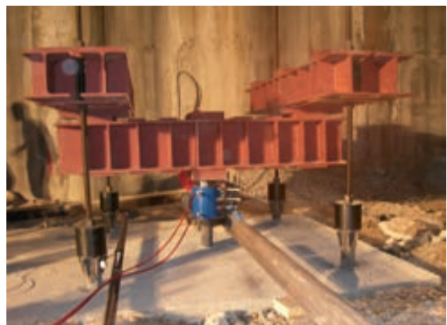
Figura 36. Prueba de carga de micropilote
