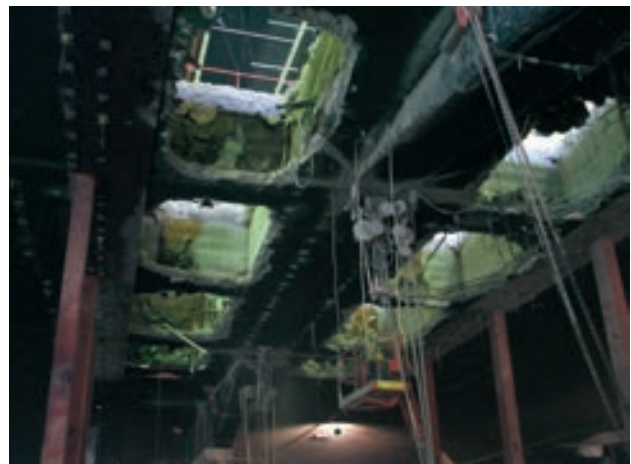
Figura 5. Huecos en la losa vista inferior
