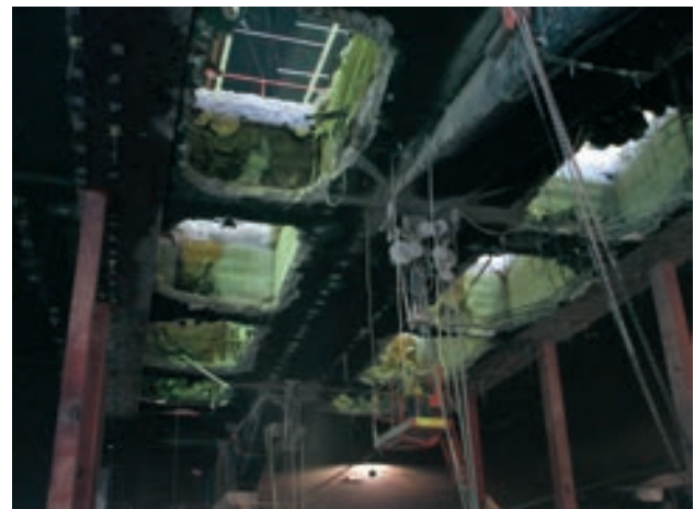
Figura 5. Huecos en la losa vista inferior
