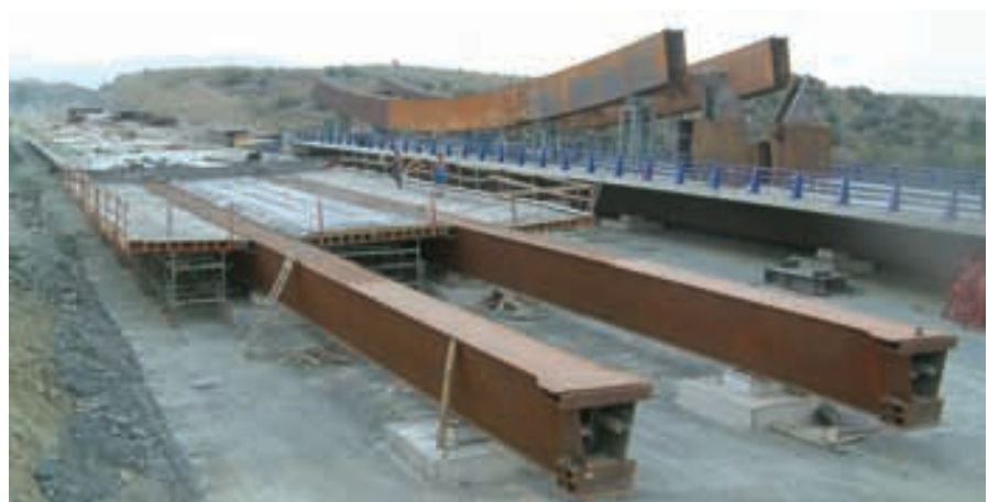
Figura 15. Construcción de tableros en tierra firme. En primer plano, construcción de losa superior, de uno de los tableros. Al fondo un tablero totalmente construido, incluida barrera de seguridad. Sobre el tablero, pieza correspondiente al primer cuarto de arco. Figure 15. On land deck construction. In the foreground, one of the decks' top slab construction. In the background, a completely built deck, including safety barrier. On the deck, part of the first quarter arch.
