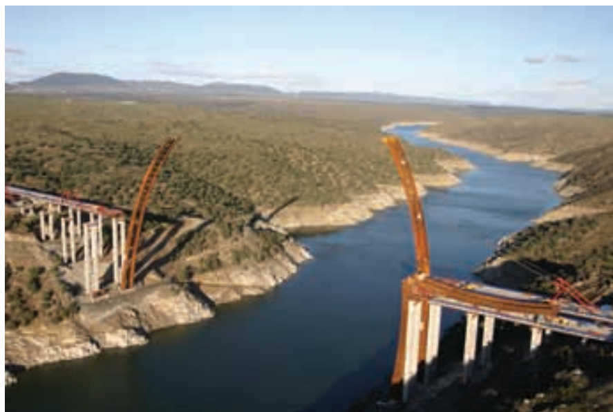
Figura 55. Embalse de Alcántara. Perspectiva general de la zona Situación de la obra con semiarcos en posición vertical. Figure 55. Alcántara Reservoir. General perspective of the area. Location of the construction with semi-arches in vertical position.
