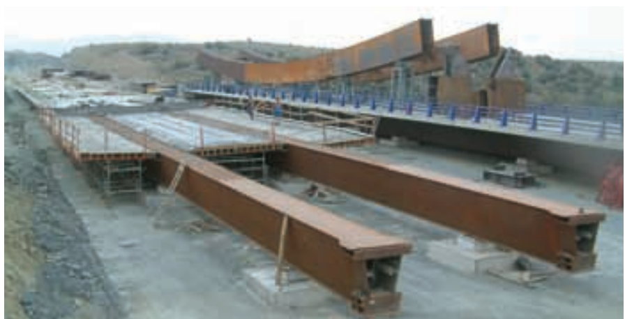
Figura 15. Construcción de tableros en tierra firme. En primer plano, construcción de losa superior, de uno de los tableros. Al fondo un tablero totalmente construido, incluida barrera de seguridad. Sobre el tablero, pieza correspondiente al primer cuarto de arco. Figure 15. On land deck construction. In the foreground, one of the decks' top slab construction. In the background, a completely built deck, including safety barrier. On the deck, part of the first quarter arch.
