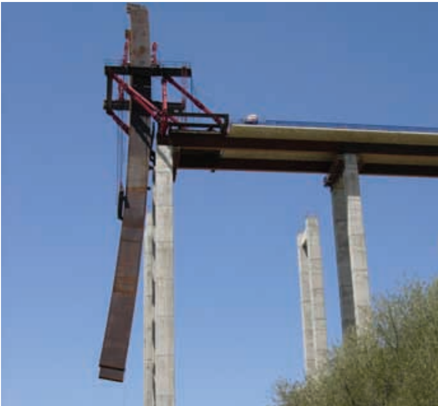
Figura 22. Descenso de primer cuarto de arco. Figure 22. Vertical lowering of first quarter arch.
