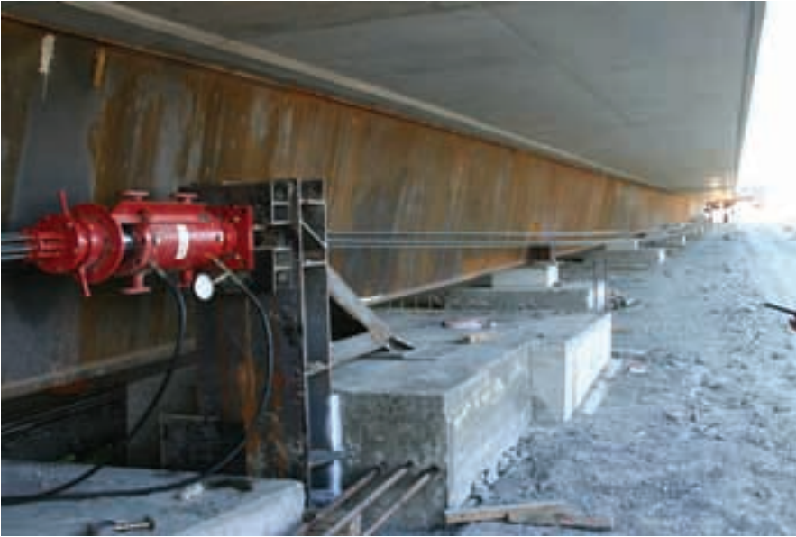
Figura 17. Gato y cable de tracción Figure 17. Jack and traction cable.
