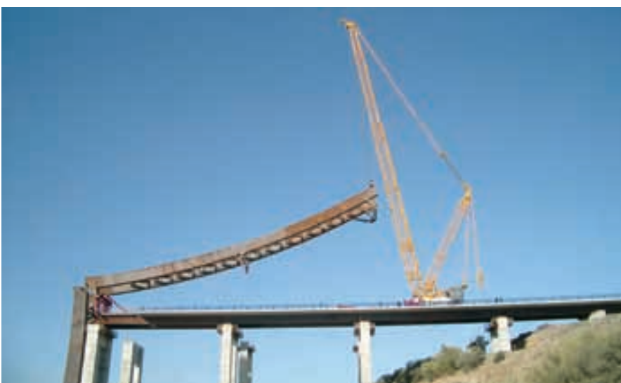
Figura 25. Izado de segundo cuarto de arco con grúa. Figure 25. Crane hoisting a second quarter arch.
