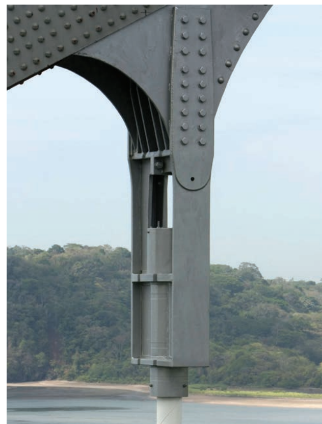
Figura 26. Detalle del anclaje superior y la conexión con el arco de la nueva péndola
