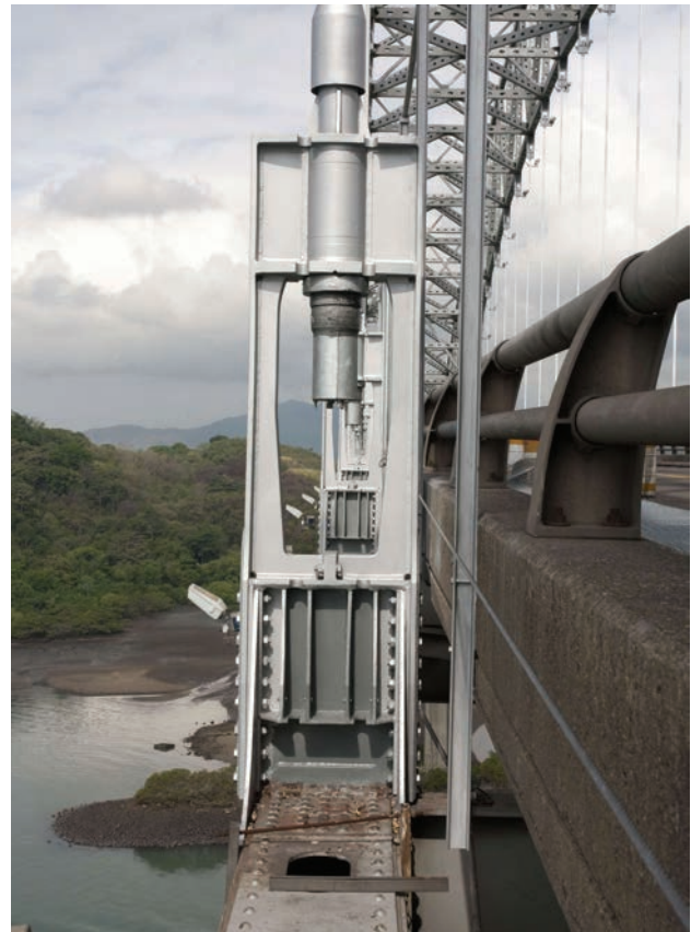
Figura 25. Detalle del anclaje inferior y la conexión con el tablero de la nueva péndola
