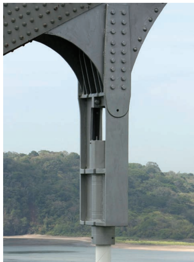
Figura 26. Detalle del anclaje superior y la conexión con el arco de la nueva péndola
