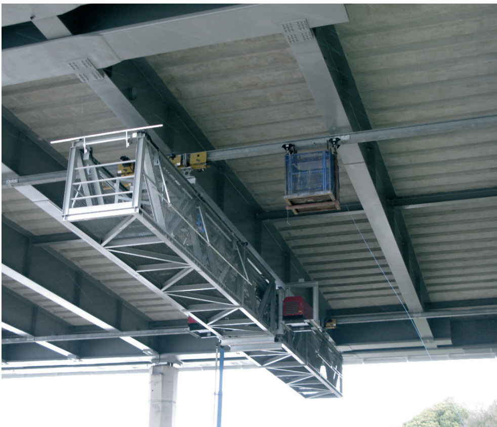
Figura 35. Carro de mantenimiento Figure 35. Maintenance gantry
