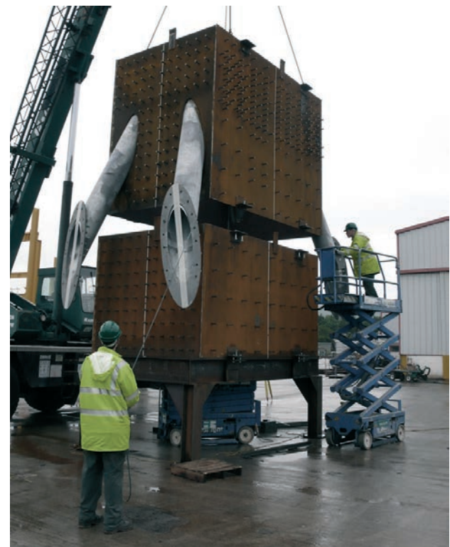
Figura 11. Montaje en blanco de cajones en taller Figure 11. Trial assembly of the boxes at workshop
