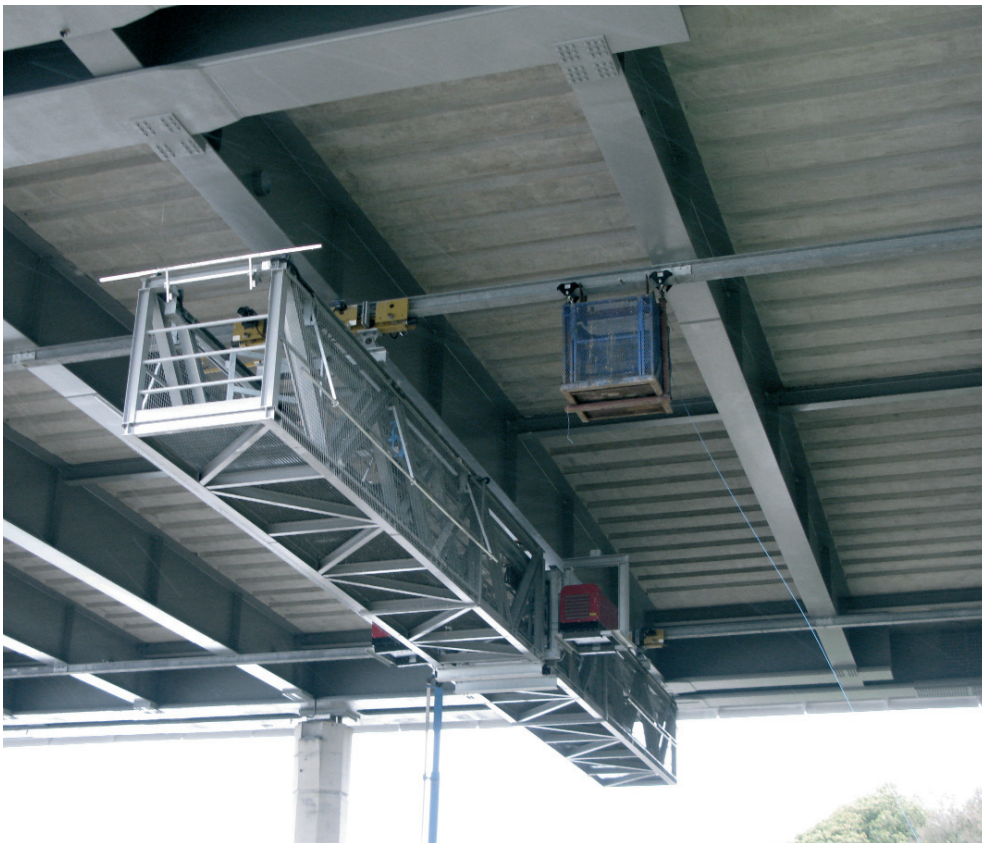
Figura 35. Carro de mantenimiento Figure 35. Maintenance gantry
