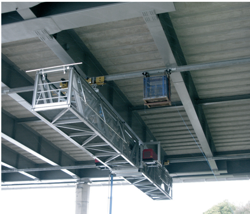
Figura 35. Carro de mantenimiento Figure 35. Maintenance gantry
