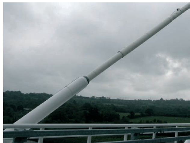
Figura 30. Tubo antivandálico y acelerómetro colocado en un tirante Figure 30. Anti-vandalism tube and accelerometer installed on a cable
