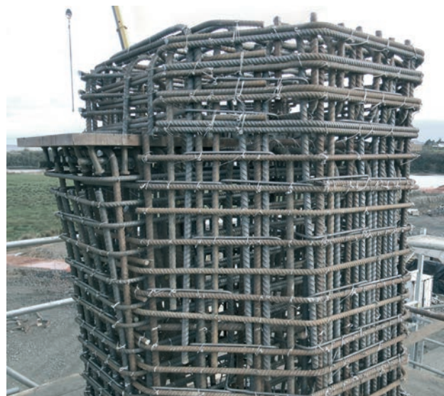
Figura 15. Armado de la cabeza de una pila Figure 15. Reinforcement of one pier
