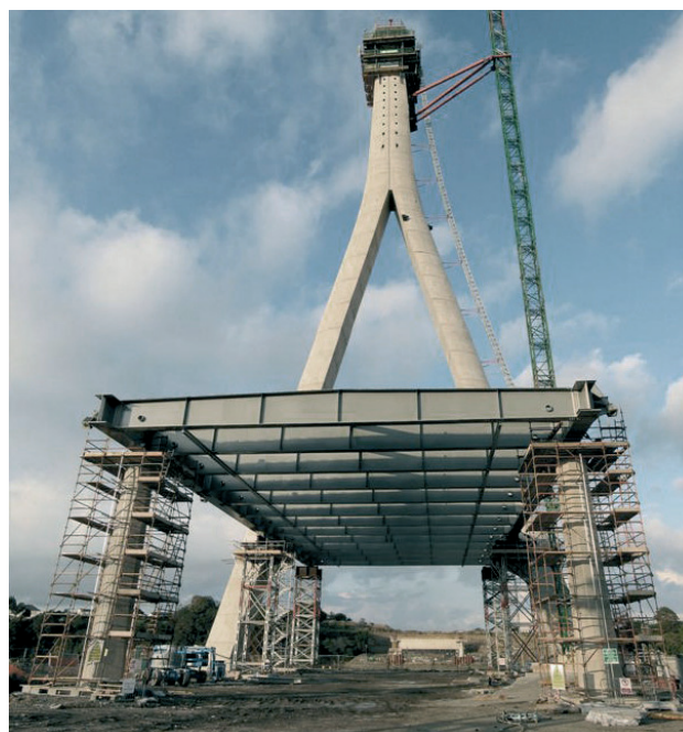
Figura 36. Montaje de estructura metálica en vanos traseros. Figure 36. Installation of steel structure in back spans.
