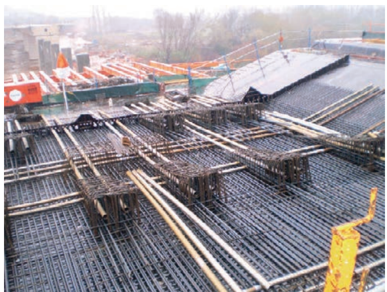
Figura 7. Colocación de vainas de pretensado longitudinal en el último tercio del tablero
