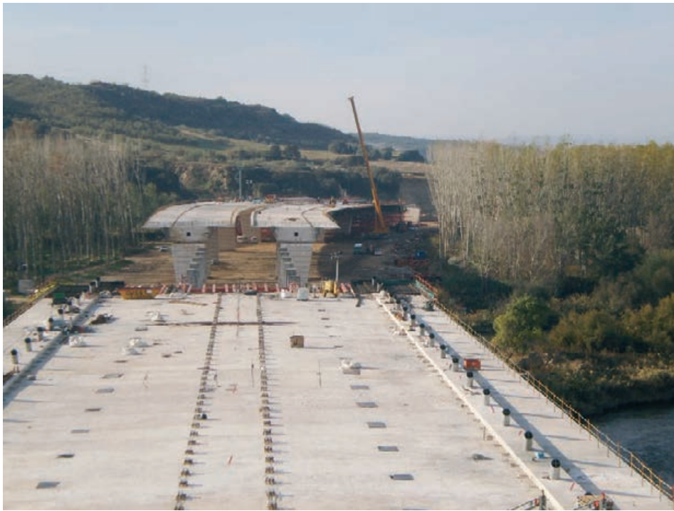
Figura 36. Avance del tablero del puente atirantado. Al fondo, los tableros del viaducto de acceso Figure 36. Cable-stayed bridge deck construction with the approach viaduct decks in the background
