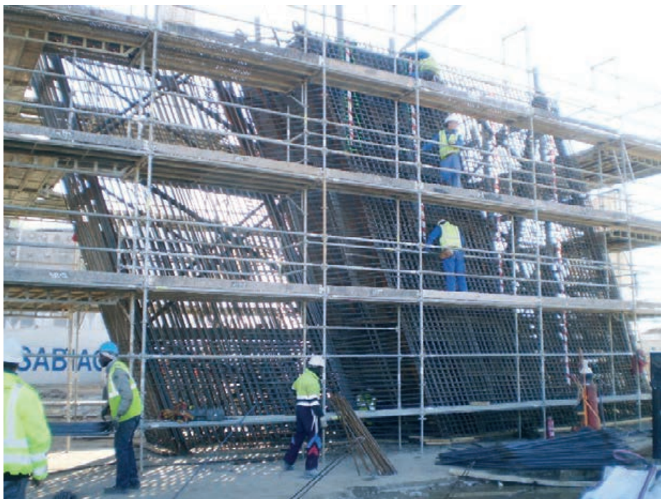
Figura 40. Célula metálica y ejecución de ferrallado a nivel de suelo para su posterior izado Figure 40. Steel cage and ground level assembly of reinforcement for subsequent hoisting
