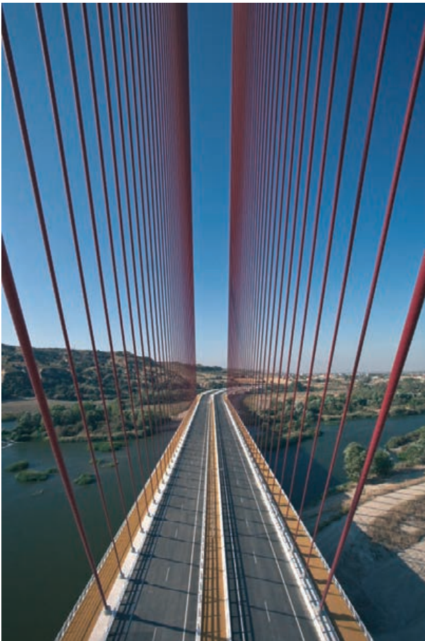
Figura 13. Tirantes de sustentación del tablero en dos planos de 38 cables cada uno
