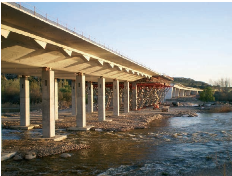
Figura 34. Tablero apoyado sobre pilas provisionales. Al fondo el viaducto de acceso Figure 34. Deck resting on provisional piers with approach viaduct in the background
