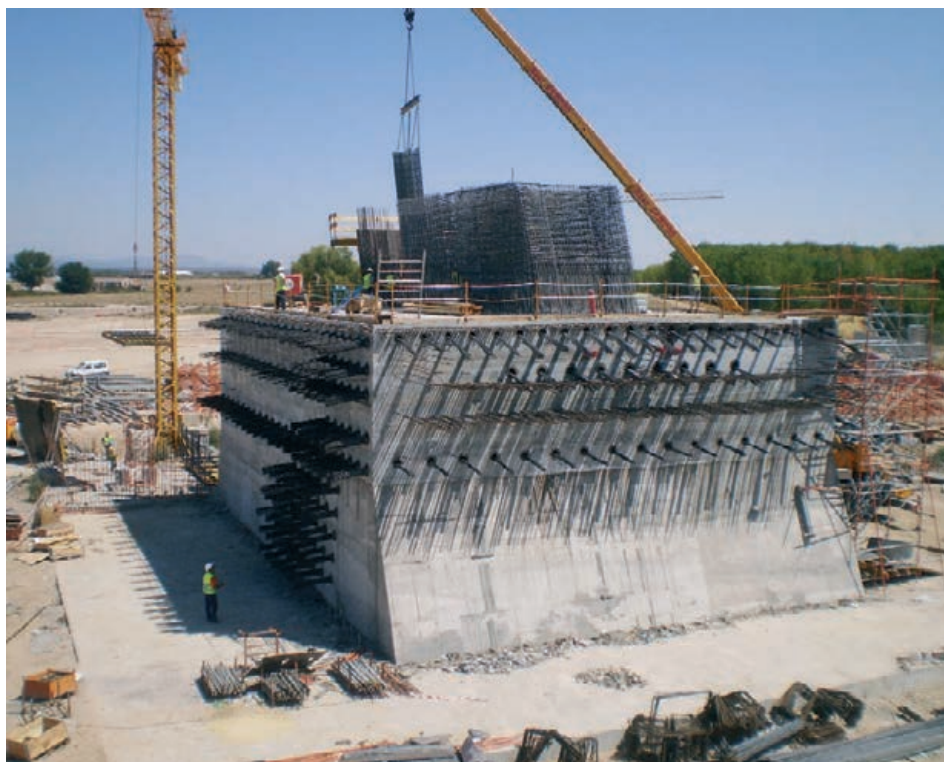
Figura 26. Mamparo en hormigón gris. Arranque de armado de pilono y pretensado transversal del mamparo Figure 26. Grey concrete bulkhead: pylon reinforcement springing and transverse prestressing in bulkhead
