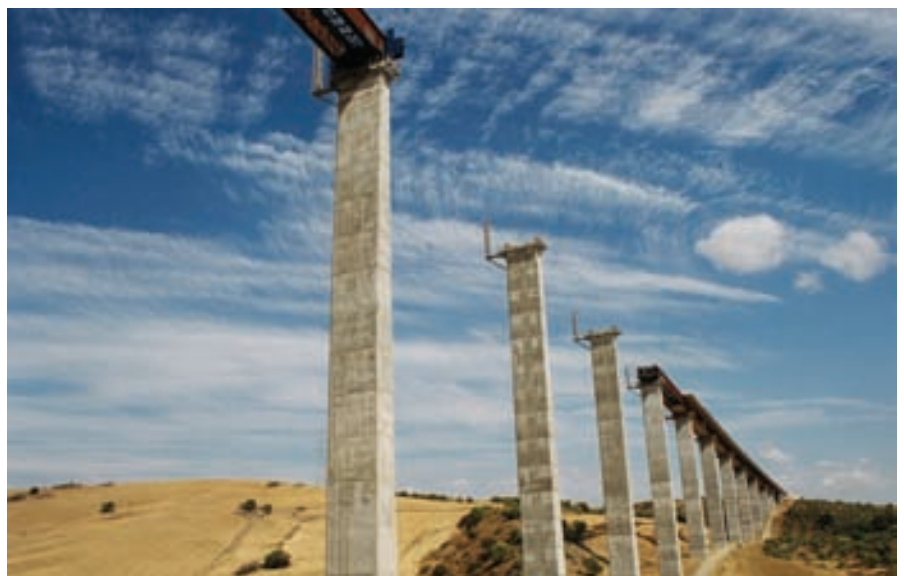
Fig. 22. Vista inferior del viaducto durante el empuje desde los dos estribos Fig. 22. View of the underneath of the viaduct during launching from the two abutments
