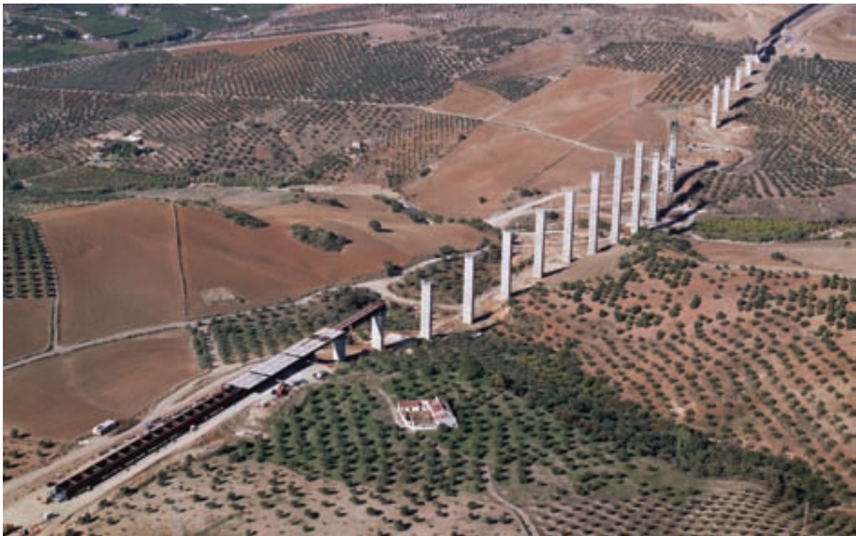
Fig. 11. Vista aérea del viaducto en construcción, con parte del tablero en el parque de empuje del Estribo 2. Fig. 11. Aerial view of the viaduct under construction, with part of the deck in the Abutment 2 launching yard
