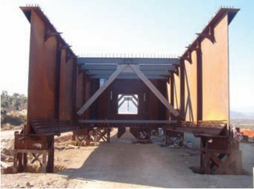
Fig. 10. Estructura metálica apeada en el parque de empuje. Ejecución por Dovelas. Fig. 10. Metal structure propped up in the launching yard. Segment construction.
