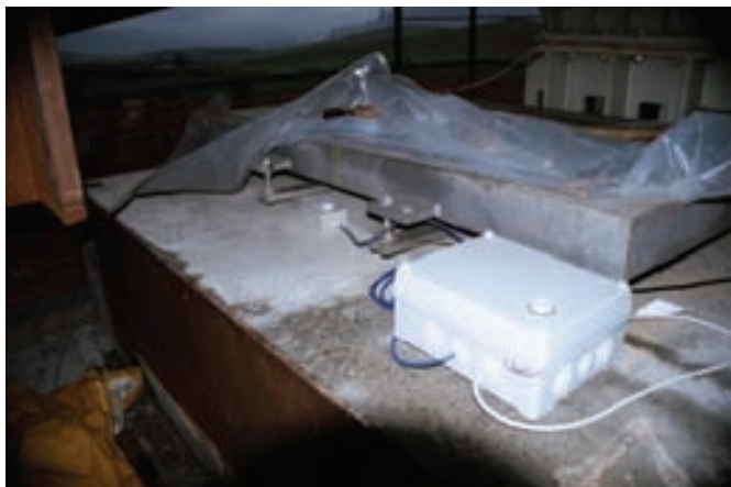
Fig. 33. Vista del clinómetro sobre pila. Fig. 33. View of the clinometer on a pier.
