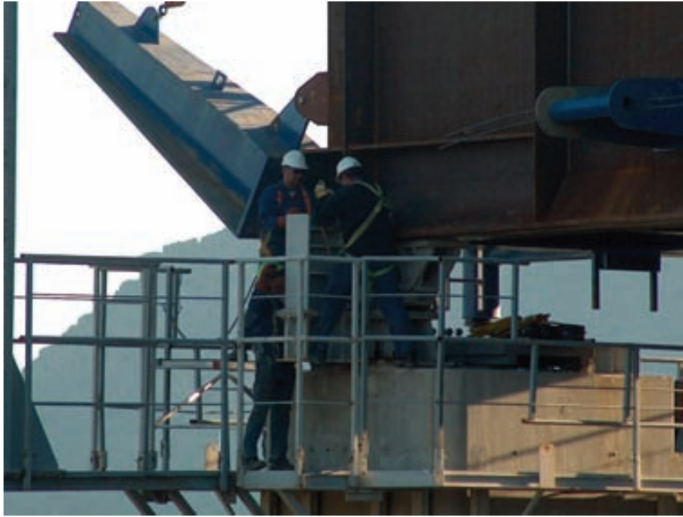
Fig. 21. Operación de paso de pila y repliegue de patines. Fig. 21. Pier passing and nose beam raising.
