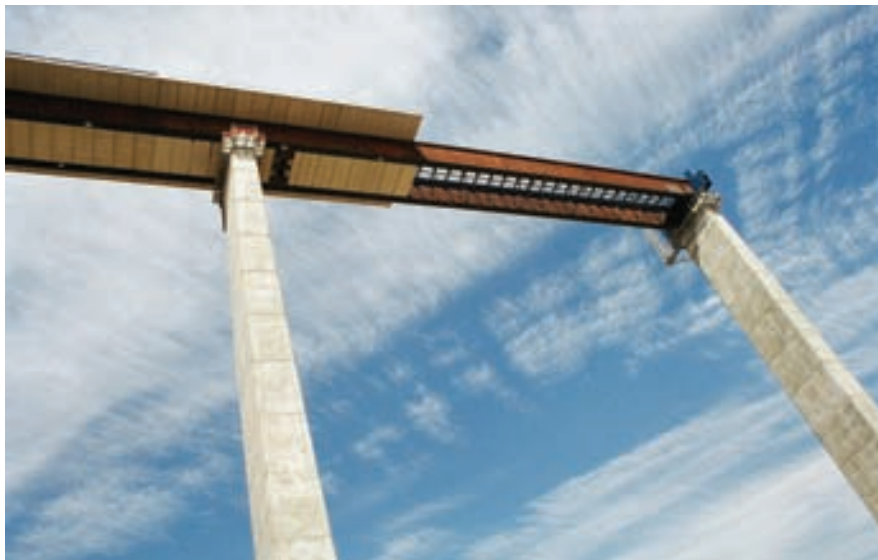
Fig. 14. Vista del primer vano sin prelasas superiores ni inferiores durante el empuje. Fig. 14. View of the first span with no top or bottom pre-slabs during launching
