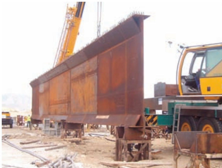
Fig. 9. Transporte y colocación de una viga metálica. Fig. 9. Transporting and placing a metal girder.
