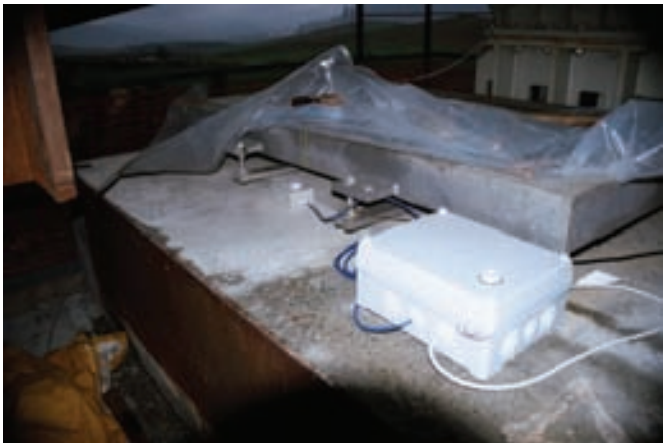
Fig. 33. Vista del clinómetro sobre pila. Fig. 33. View of the clinometer on a pier.
