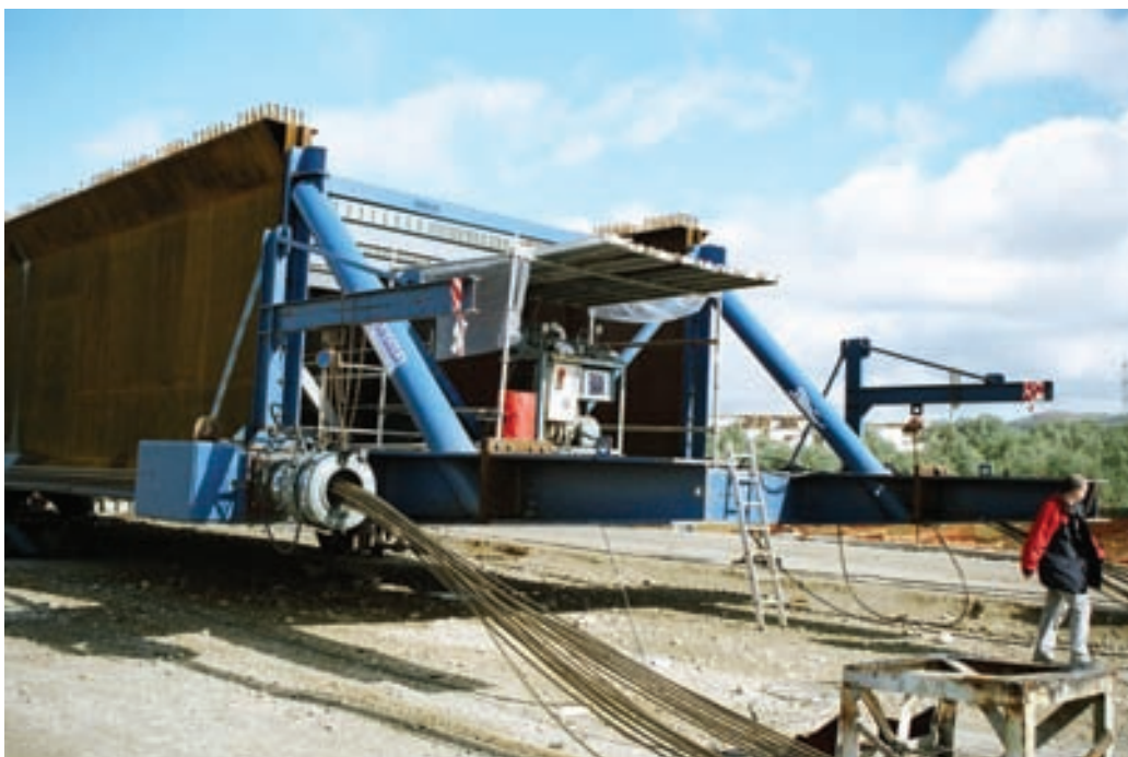
Fig. 17. Detalle de la estructura auxiliar de empuje y los cables y gatos de empuje. Fig. 17. Detail of the auxiliary launching structure and the launching cables and jacks
