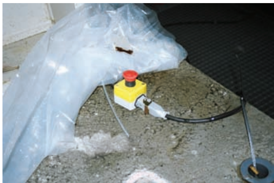
Fig. 35. Vista del sistema de parada en cada pila (Seta). Fig. 35. View of the stop system at each pier (Mushroom).
