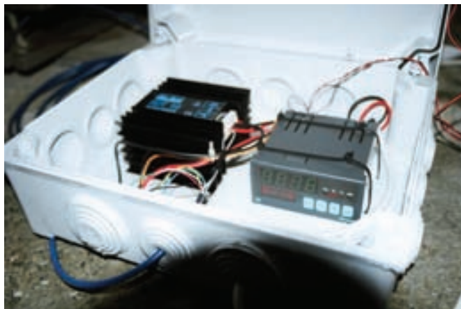
Fig. 34. Caja con convertor de señal del clinómetro y con el limitador de giro máximo admisible Fig. 34. Box with a clinometer signal converter and with the maximum admissible rotation limiter
