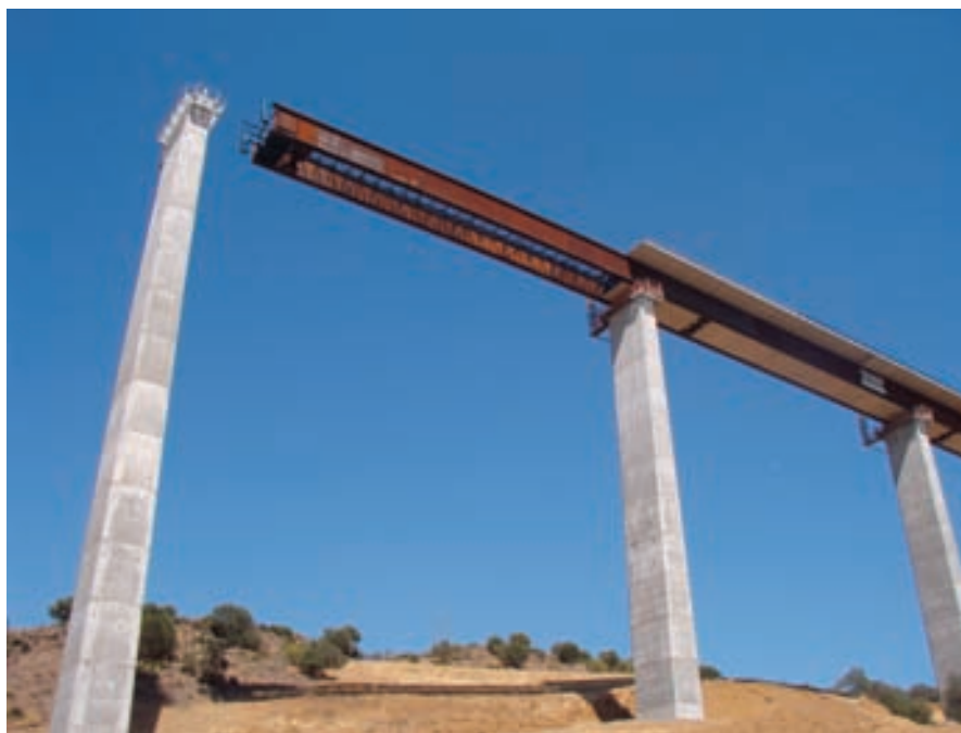
Fig. 23. Vista del voladizo antes de llegar a pila durante el empuje. Fig. 23. View of the cantilever before reaching a pier during launching.
