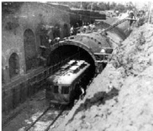
Figura 1. Obras originales de la cobertura de la línea entre 1920 y 1930 (Fuente: FGC)
