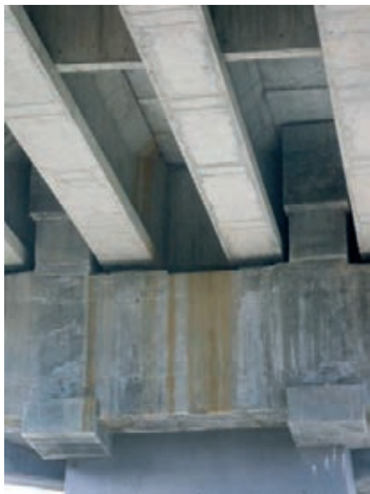
Figura 48. Vista de las vigas de cuelgue (entre las vigas del tablero) y la parte central del dintel nuevo. Se aprecian los regresamientos correspondientes a los anclajes del pretensado
