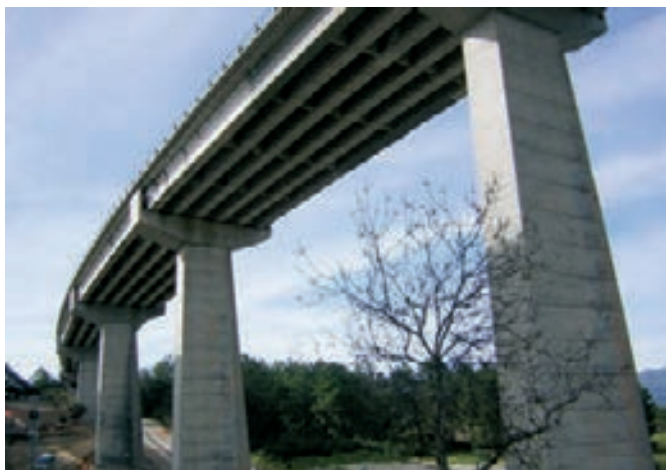
Figura 2. Viaducto de La Jarosa (calzada sentido La Coruña) antes de la intervención
