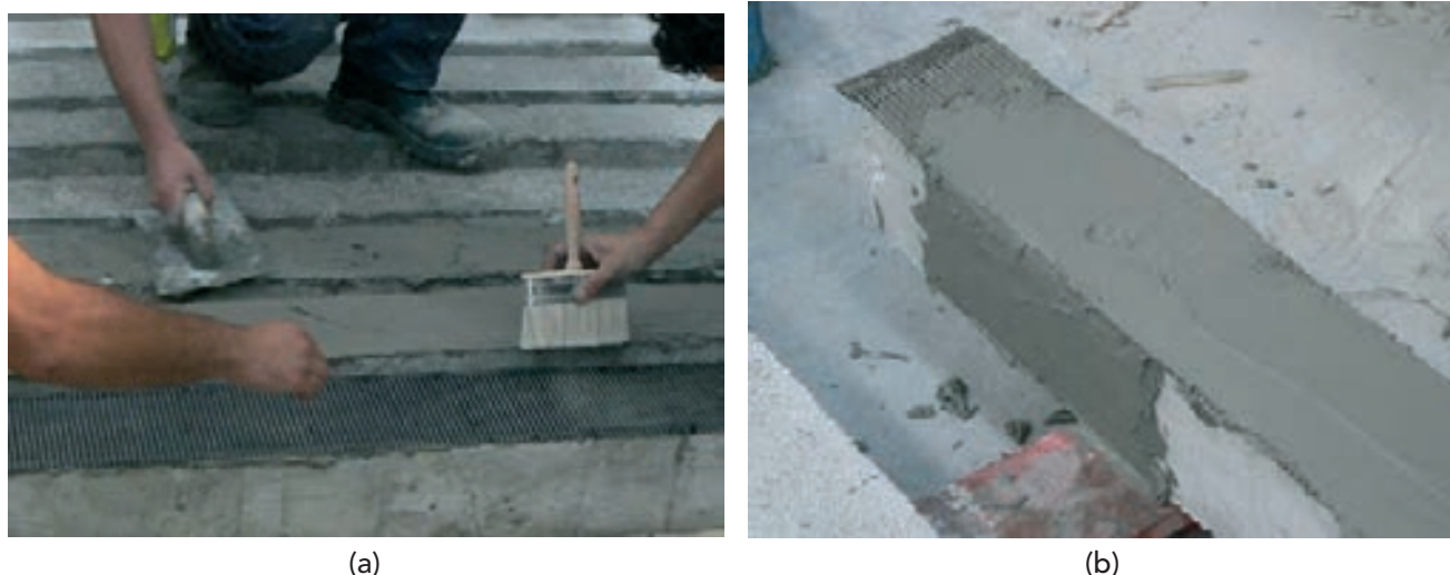
Figura 6. Aplicación de tejido de carbono como refuerzo interno del TRM y detalle de anclaje en forma de U
