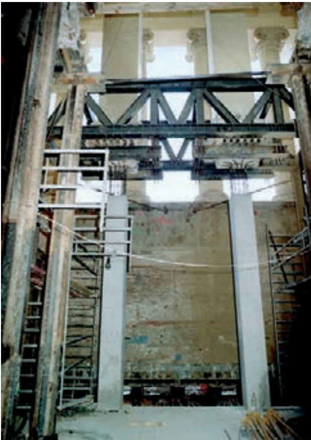
Figura 15. Estructura de recalde y definitiva. Columnata interior de la fachada de Velázquez Bosco
