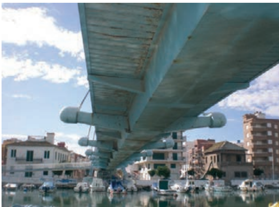
Figura 4. Aspecto en 2010 del tablero
