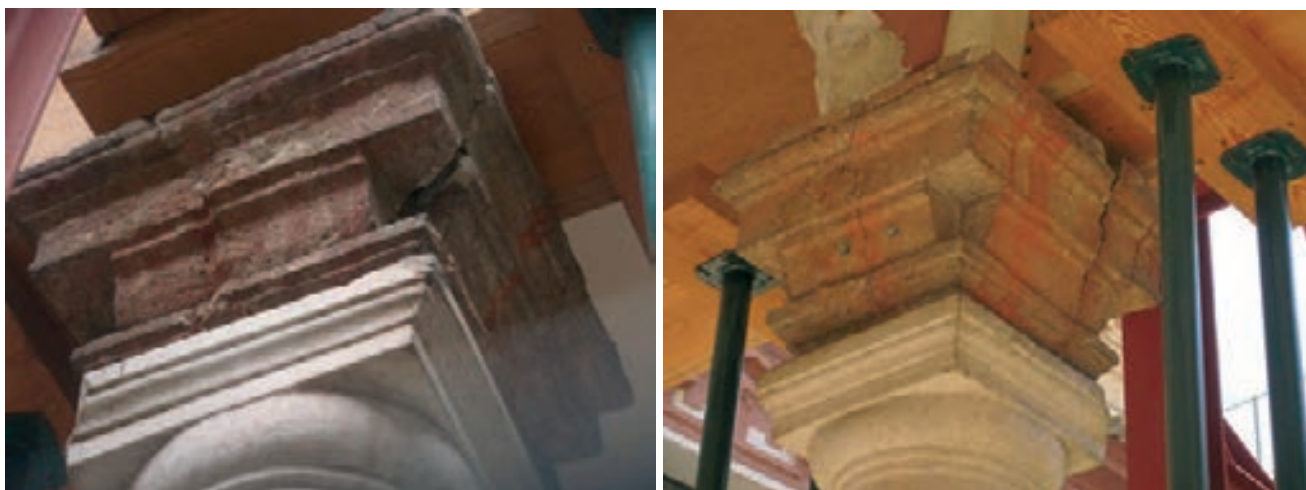
Figura 3. Grietas y fisuras en el cimacio más afectado
