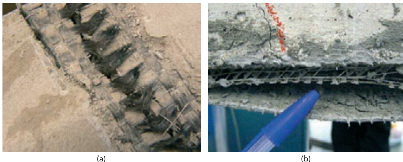
Figura 7. Rotura del tejido de fibra de carbono y despegue prematuro del TRM, localizado entre dos capas de refuerzo de acero
