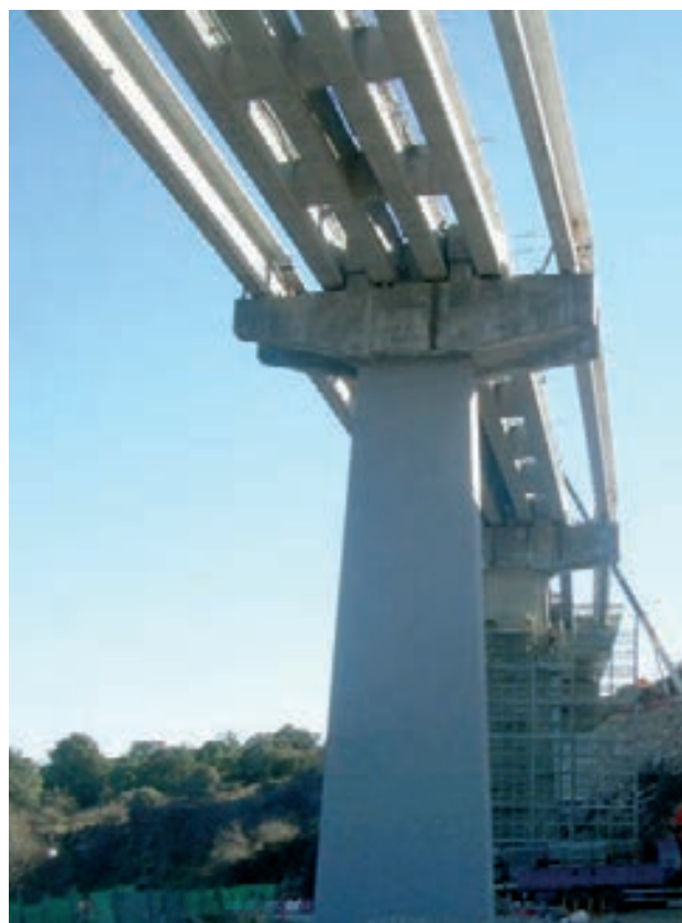
Figura 38. Vista de un vano con la losa superior demolida y las vigas extremas sustituidas por las nuevas
