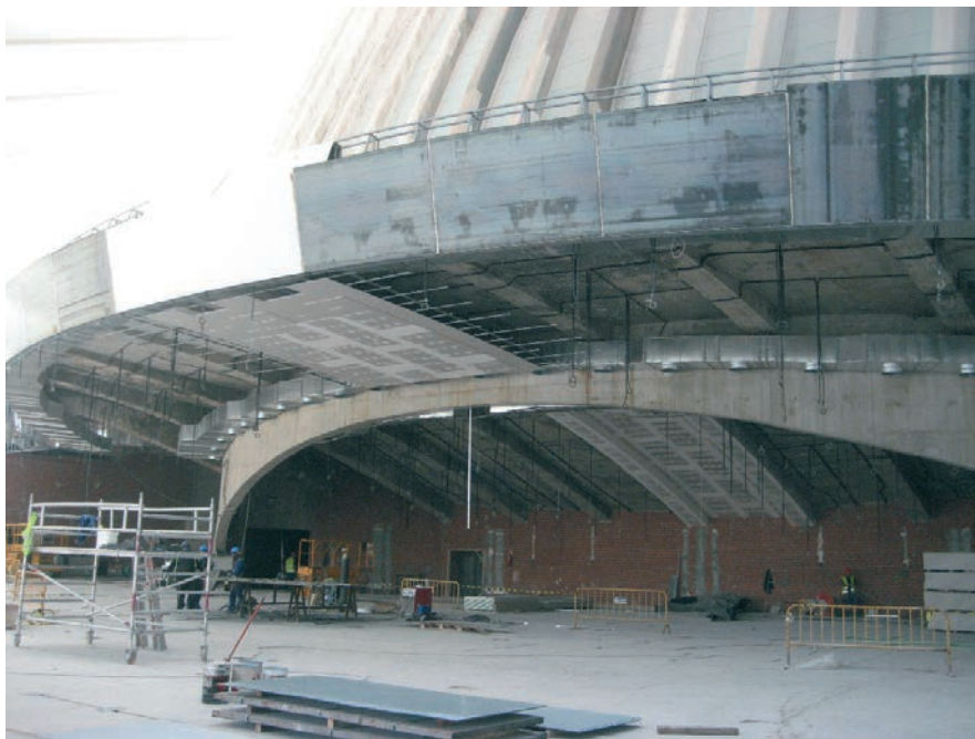
Figura 31. Vista general de la zona inferior de la losa del graderío con el muro circular y las vigas descolgadas Figure 31. General view of the lower surface of the grandstand slab with the circular wall and the downstand beams
