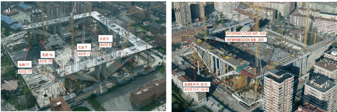
Figura 42. Situación de las torres de apeo: a) en los edificios de consejerías; b) en el edificio del hotel Figure 42. Location of the auxiliary structures: a) in the office buildings; b) in the hotel building in the office buildings
