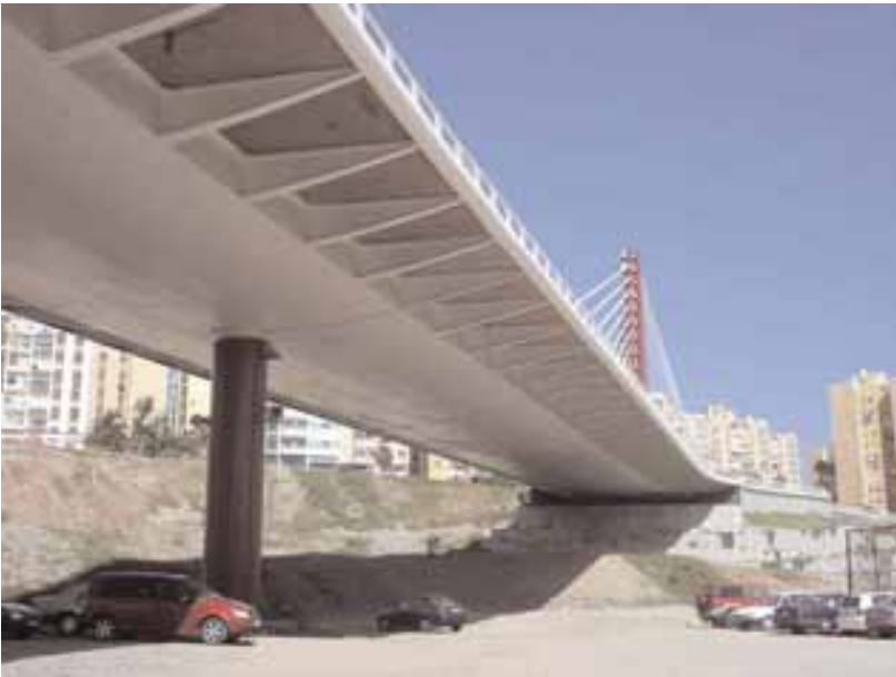
Figura 7. Vista del viaducto desde el parque. Figure 7. View of the viaduct from the park.
