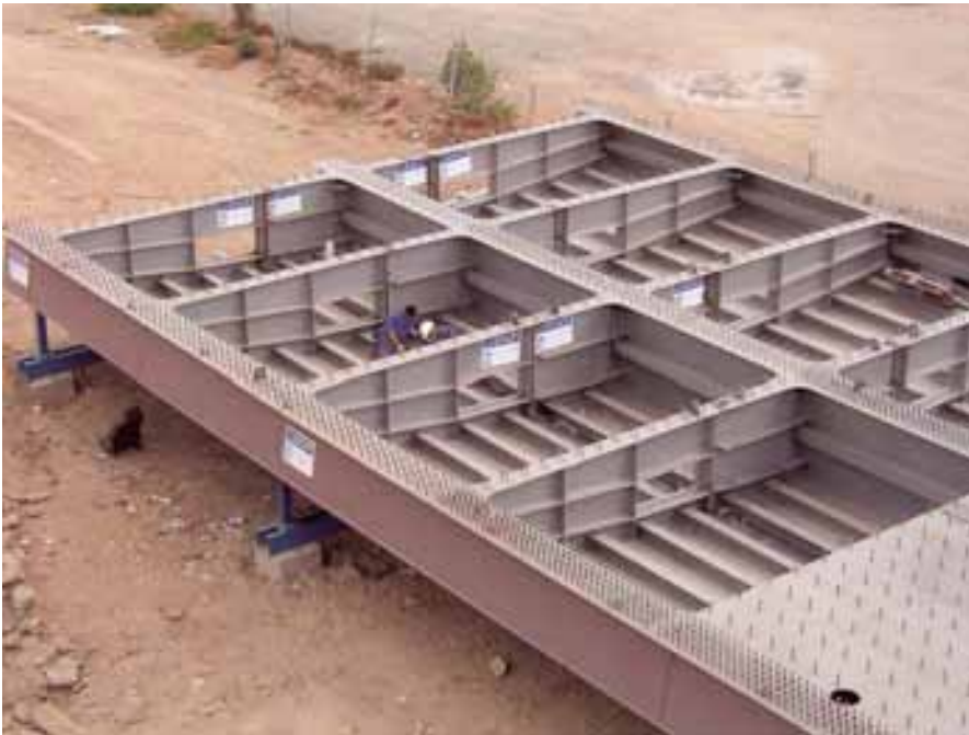
Figura 32. Unión de módulos en obra sobre bancadas de apoyo. Figure 32. Onsite welding of modules on support benches
