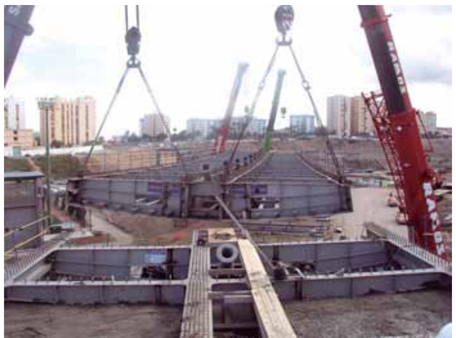
Figura 33. Izado de las dovelas 2, 3 y 4 del tablero. Figure 33. Hoisting of segments 2, 3 and 4 of the deck.
