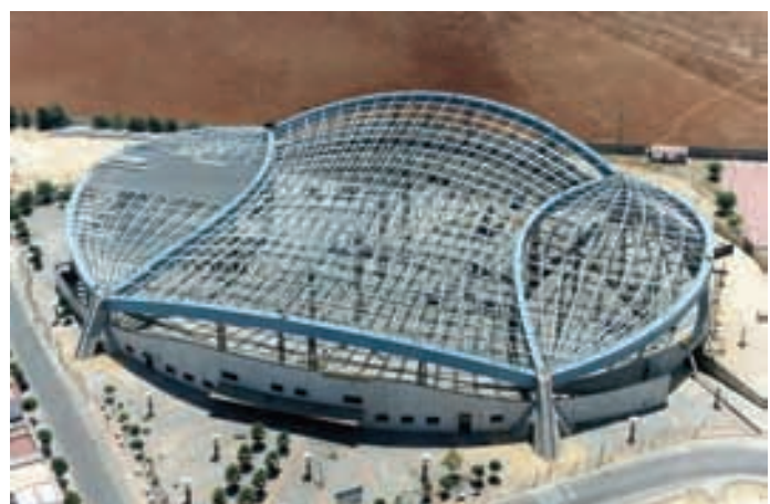
Figura 58. Vista aérea donde se ve la malla terminada, los puntales y el inicio del montaje de los elementos de la cubierta. Figure 58. Aerial shot showing the finished mesh, the struts and the first stages of the erection of the roof elements.
