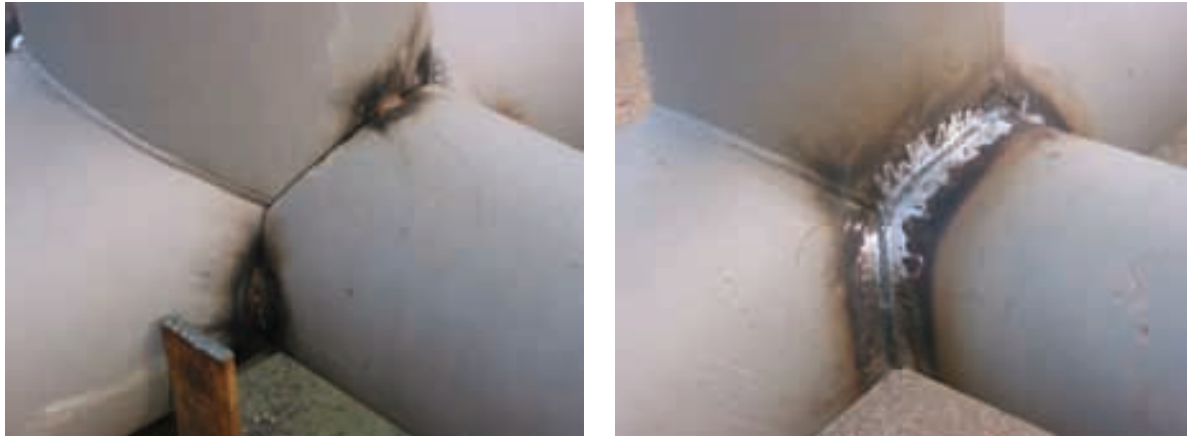
Figura 35. Soldaduras en ángulo (preparación y ejecución). Figure 35. Fillet welds (preparation and execution).
