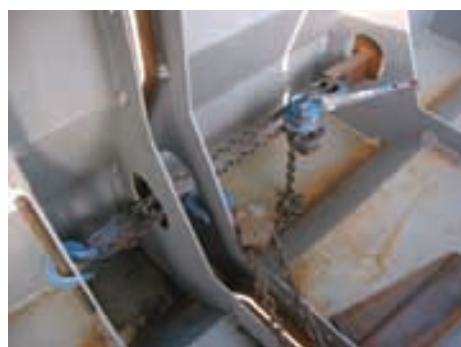
Figura 44. Utilización de los rigidizadores como auxiliares en el ensamble de cajones. Figure 44. Use of the stiffeners as auxiliary elements for the erection of caissons.
