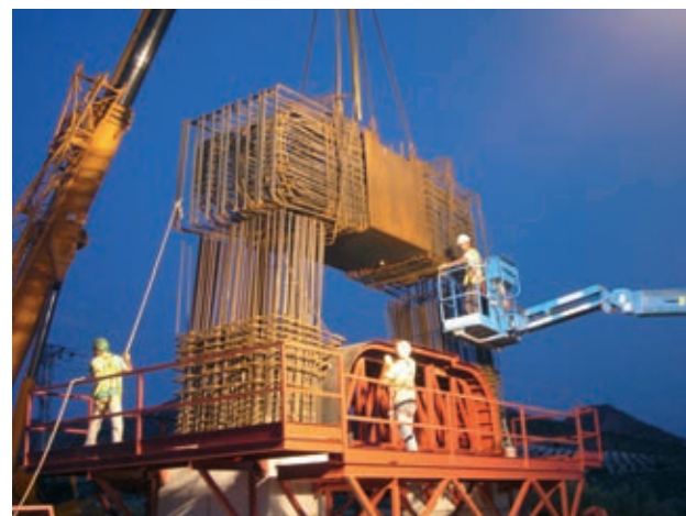
Figura 17. Ejecución de los alzados de las pilas mediante encofrado trepante y montaje de la ferralla prefabricada del dintel Figure 17. Execution of pier shafts with climbing scaffoldings and assembling of precast rebar modules of pierhead
